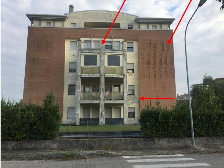
viste generali del degrado del condominio lato ovest
