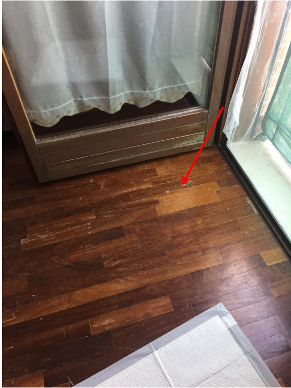
ulteriore particolare degrado rilevato nel pavimento dell'appartamento
