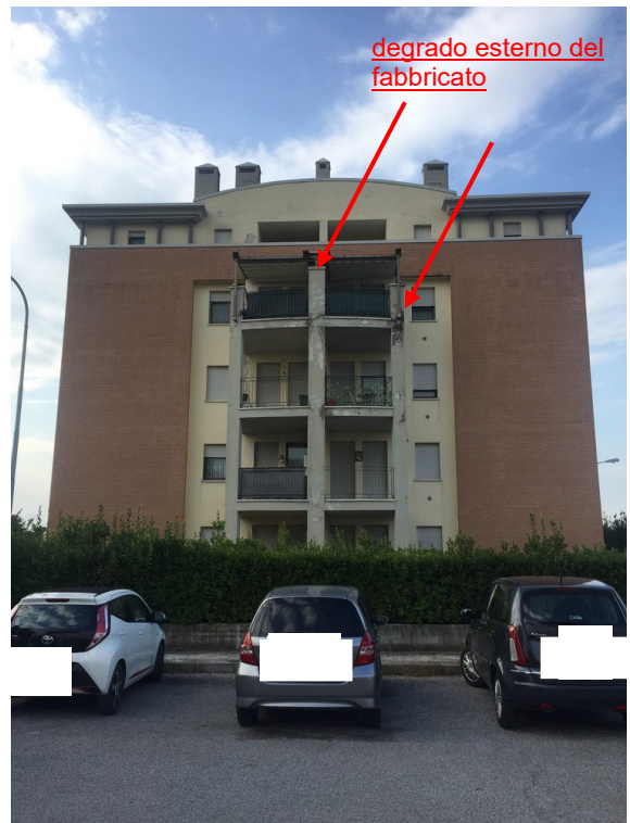
viste generali del degrado del condominio lato est
