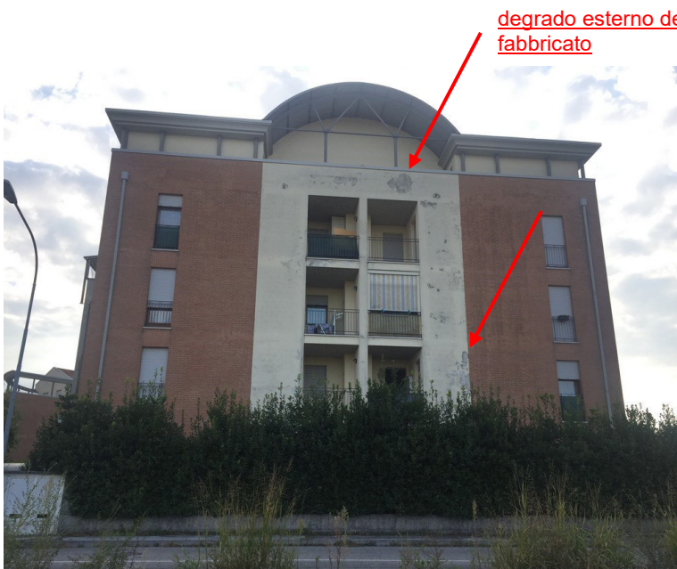
viste generali del degrado del condominio lato nord
