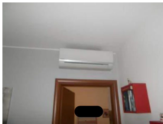
190. Impianto di condizionamento
