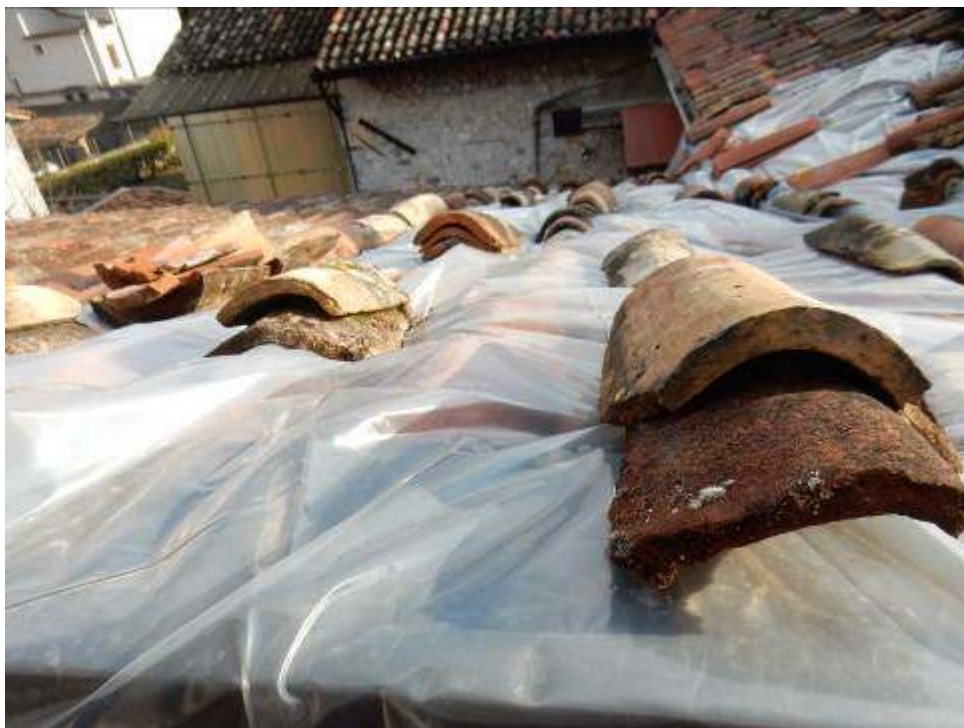
Foto 39-40: Fabbricato sub.3 – Copertura danneggiata.
