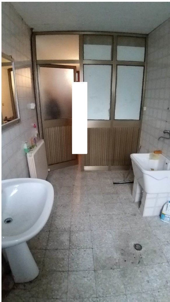
Foto n° 53 – Lotto 1 - Comune di Travesio (PN) – Foglio 20 m.le 87 sub 1 – Piano scantinato. Veduta della porzione est del bagno di cui alla foto precedente; in fondo la porta di accesso al disimpegno.
