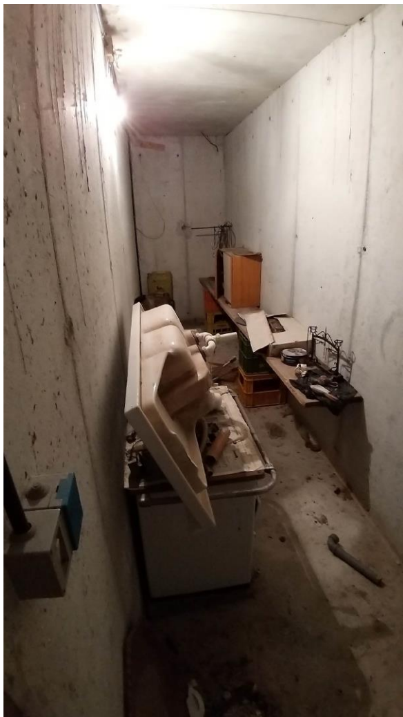
Foto n° 47 - Lotto 1 - Comune di Travesio (PN) - Foglio 20 m.le 87 sub 1 - Piano scantinato. Veduta, da posizione ovest, del vano lungo e stretto adiacente alla cucina, adibito a deposito.
