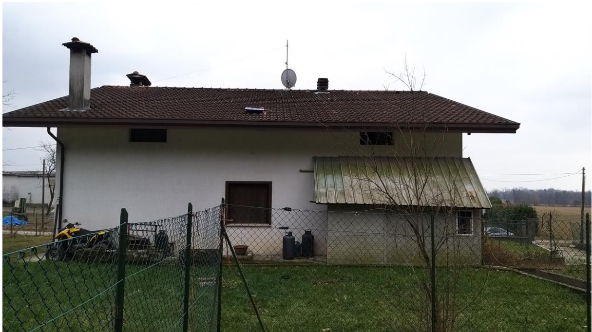
Foto n° 11 – Lotto 1 - Comune di Travesio (PN) – Foglio 20 m.le 87 –Veduta, da posizione nord e dall'area recintata del secondo manufatto abusivo, del retro dell'abitazione pignorata. Nella foto si nota una tettoia abusiva, tamponata su due lati da pannelli e addossata alla parete dell'edificio principale.
