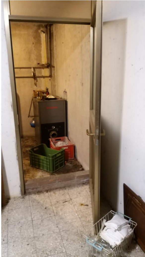
Foto n° 41 - Lotto 1 - Comune di Travesio (PN) - Foglio 20 m.le 87 sub 1 - Piano scantinato. Veduta, dal locale "lavanderia", dell'ingresso al vano uso centrale termica.
