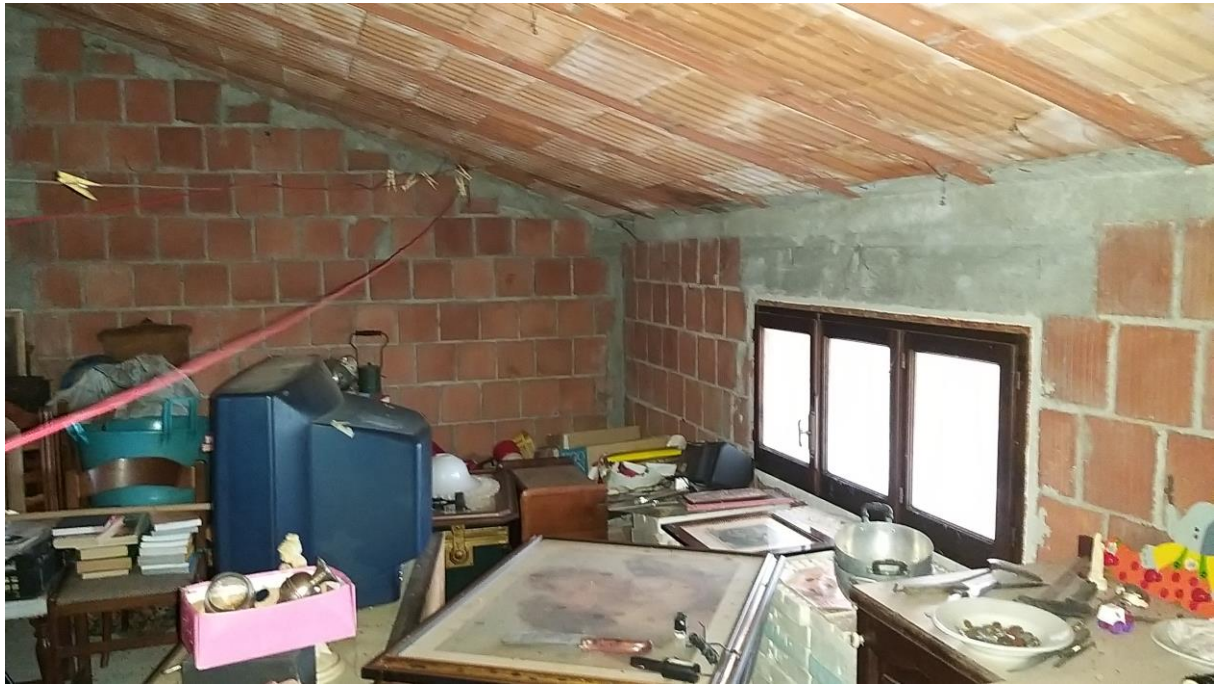
Foto n° 65 - Lotto 1 - Comune di Travesio (PN) - Foglio 20 m.le 87 sub 1 - Piano primo. Particolare della porzione sud-est della soffitta di cui alla foto precedente.
