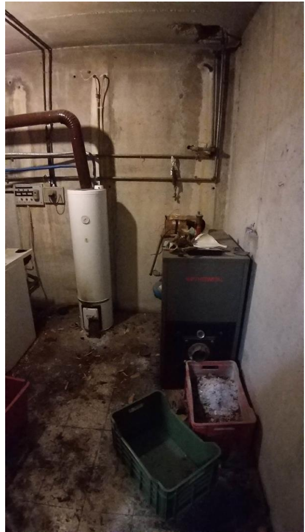
Foto n° 42 - Lotto 1 - Comune di Travesio (PN) - Foglio 20 m.le 87 sub 1 - Piano scantinato. Veduta, dalla porta di ingresso, di parte interna della centrale termica.
