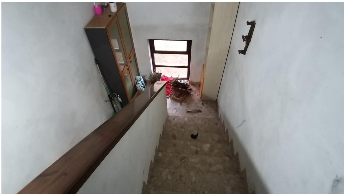
Foto n° 59 – Lotto 1 - Comune di Travesio (PN) – Foglio 20 m.le 87 sub 1 – Piano primo. Veduta, dal primo piano, del vano scale di cui alle foto precedenti.
