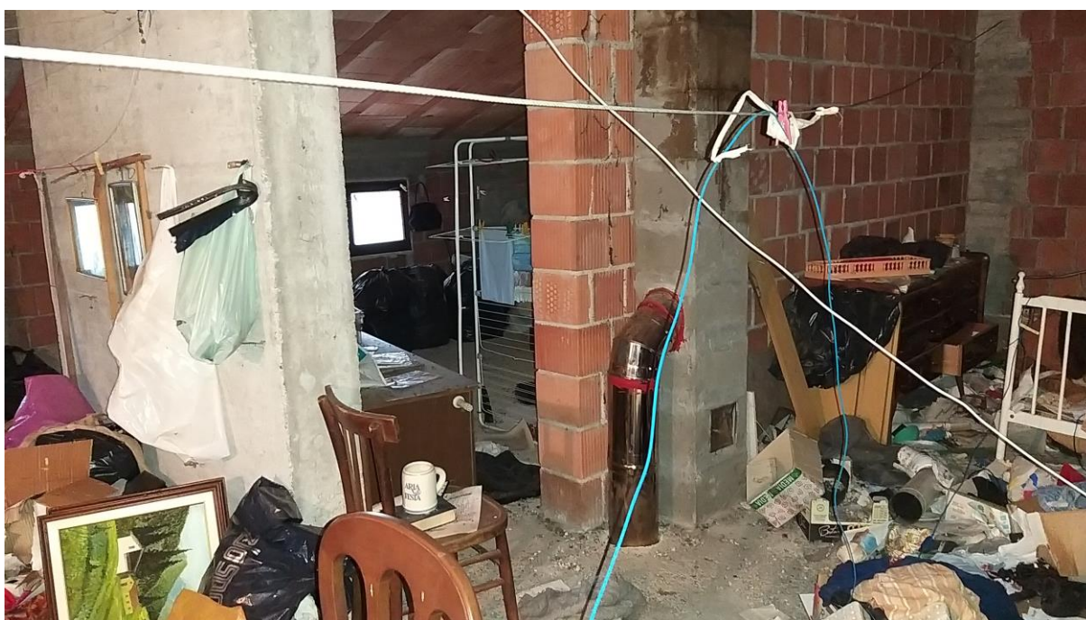
Foto n° 62 – Lotto 1 - Comune di Travesio (PN) – Foglio 20 m.le 87 sub 1 – Piano primo. Veduta, della porzione sud-ovest della stessa soffitta.
