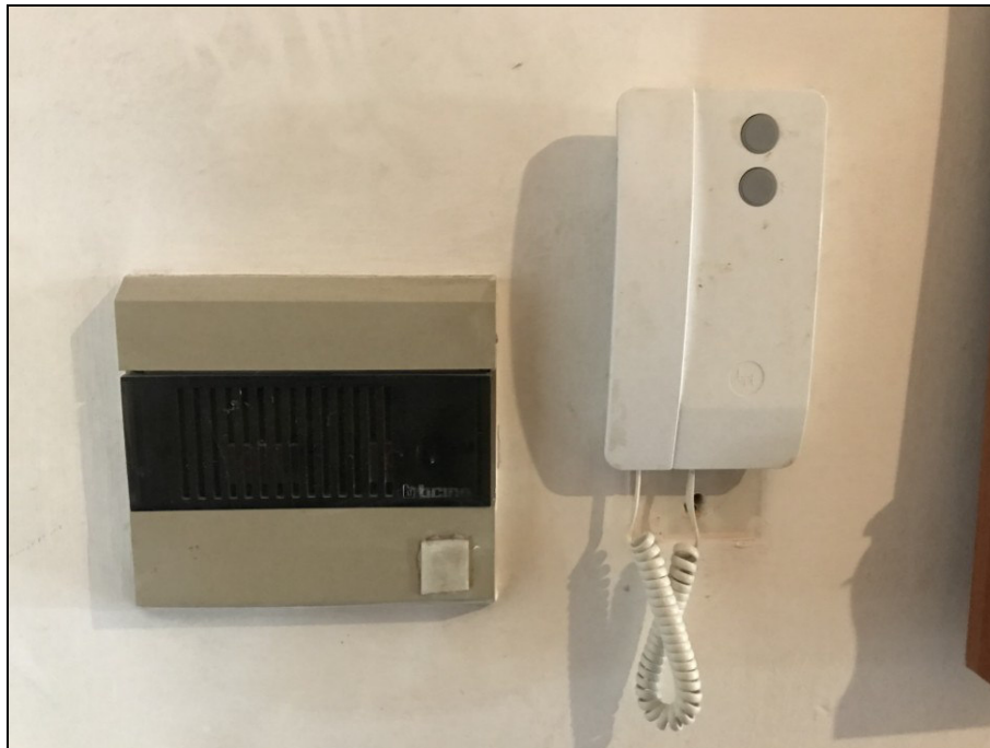
Fig.23: vista quadro impianto elettrico dell'appartamento e citofono
