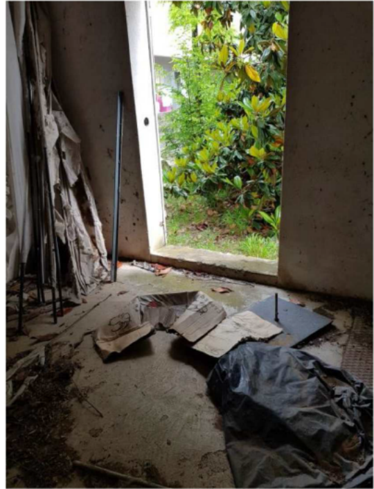
Ex cabina elettrica
