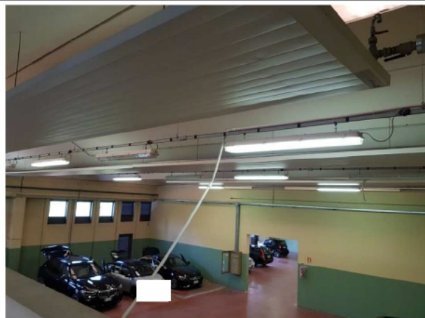
Particolare impianto di riscaldamento - Corpo B
