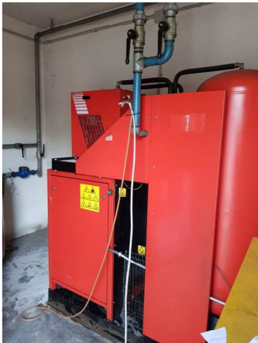
Compressore aria compressa - Corpo B
