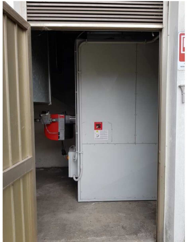
Caldaia e bruciatore - Corpo B
