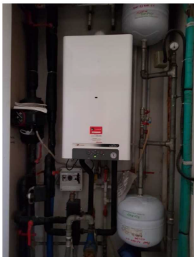
Caldaia al primo piano - corpo A
