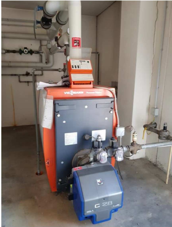
Bruciatore e caldaia - Corpo B
