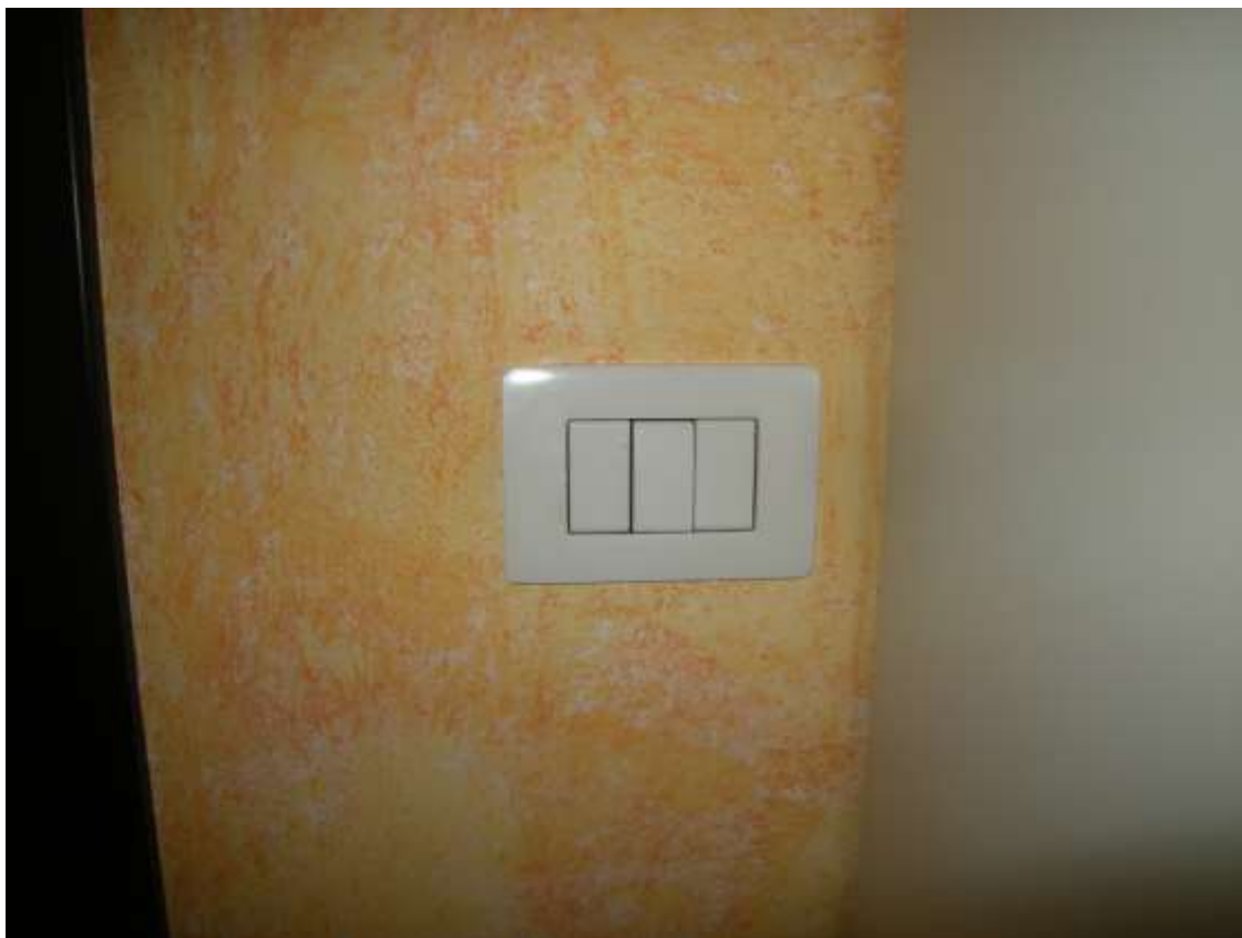
Ottava Presa (Caorle), Strada Fortuna n. 56 - Sopra il quadro elettrico, sotto gli interruttori.
