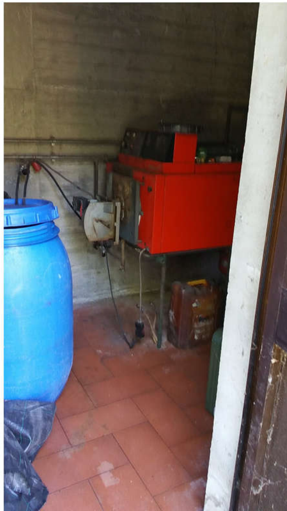
61 - centrale termica riscaldamento
