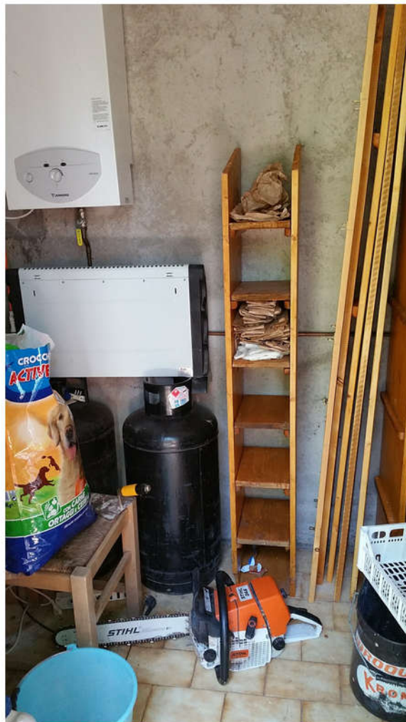
62 - centrale termica acs
