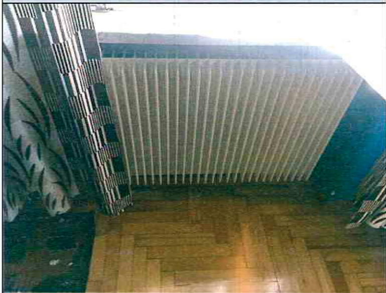
Particolare dell'impianto di riscaldamento
