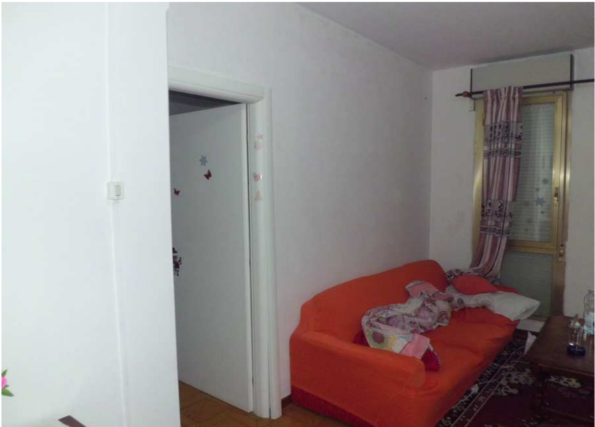
Foto n° 30 - 14/03/2019 - Comune di Maniago, foglio 20, part. 474, sub.67 – Parete in cartongesso che delimita la stanza da letto ricavata all'interno del vano catastalmente identificato come soggiorno-pranzo.
