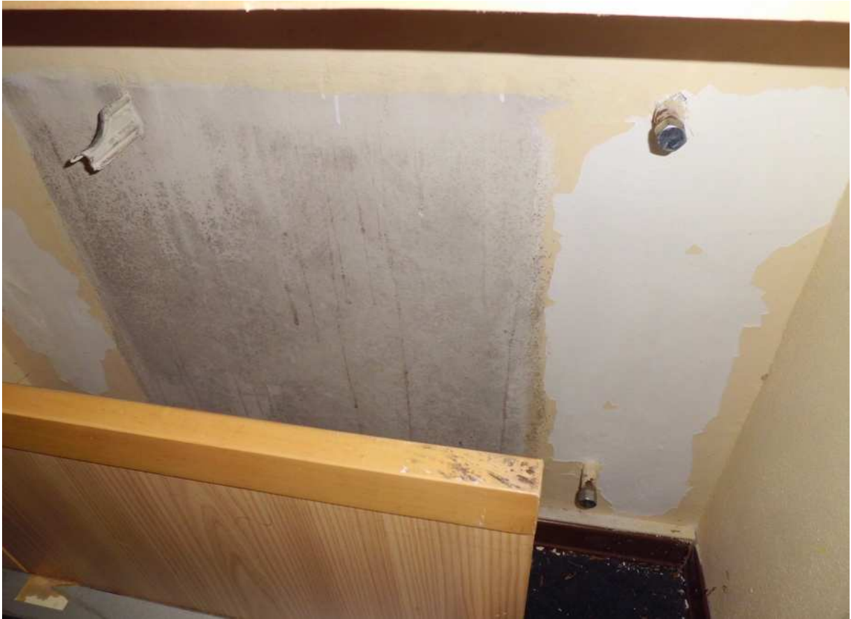
Foto n° 13 - 14/03/2019 - Comune di Maniago, foglio 20, part. 474, sub.67 – Camera. Particolare dell'impianto di riscaldamento i cui diffusori risultano scollegati.
