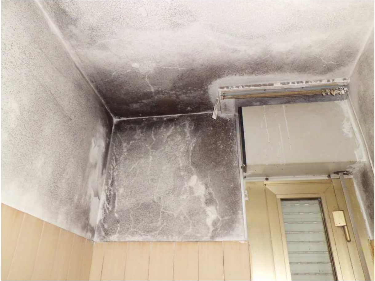
Foto n° 20 - 14/03/2019 - Comune di Maniago, foglio 20, part. 474, sub.67 – Bagno piccolo. Evidenti danni alle pareti causati dall'umidità.
