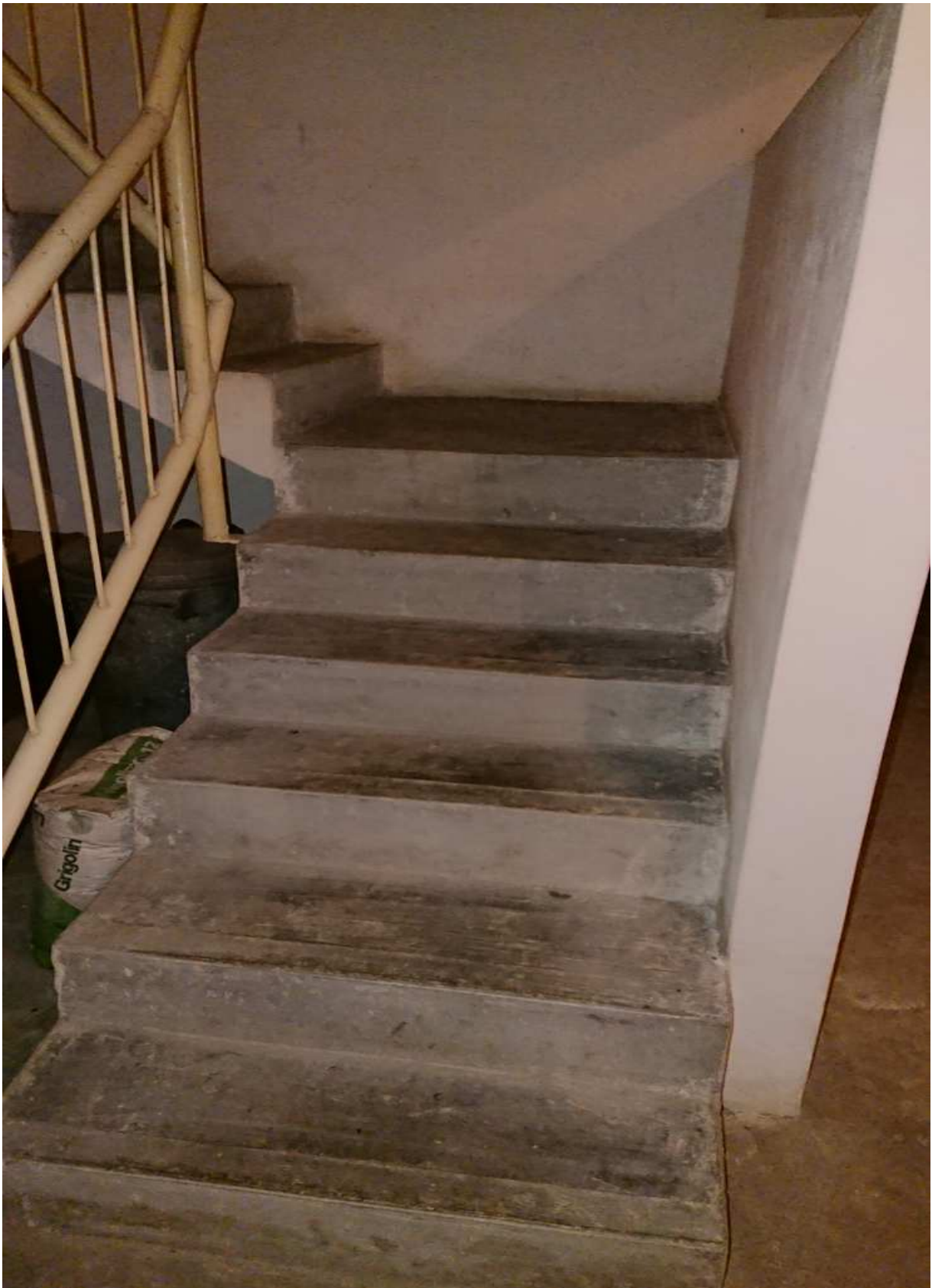
Foto n° 33 - 14/03/2019 - Comune di Maniago, foglio 20, part. 474 – Vano scale condominiale che conduce ai piani sotterranei.
