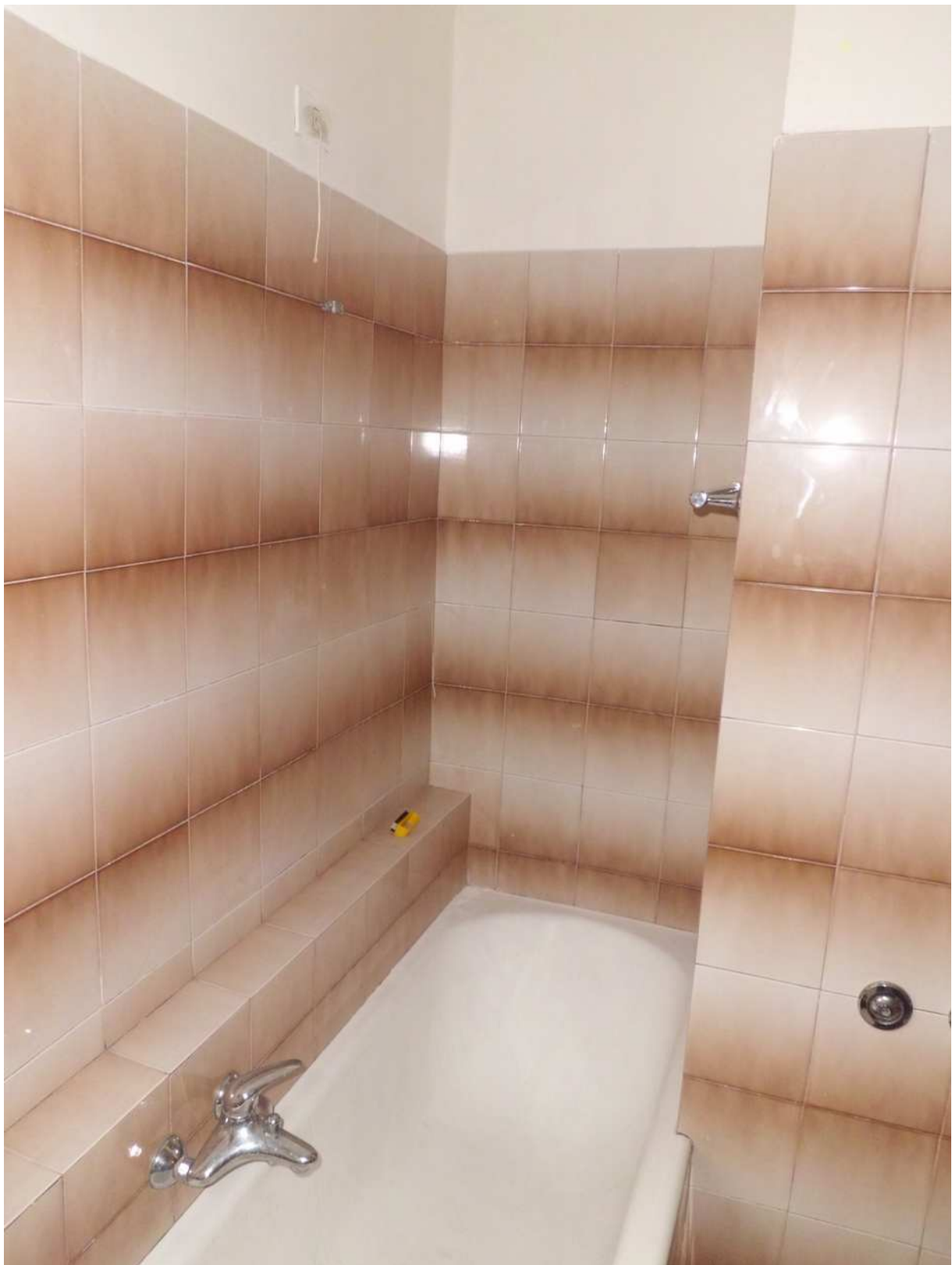
Foto n° 16 - 14/03/2019 - Comune di Maniago, foglio 20, part. 474, sub.67 – Bagno principale. Vasca da bagno. Visibile la rientranza non indicata nelle planimetrie di progetto e catastali.
