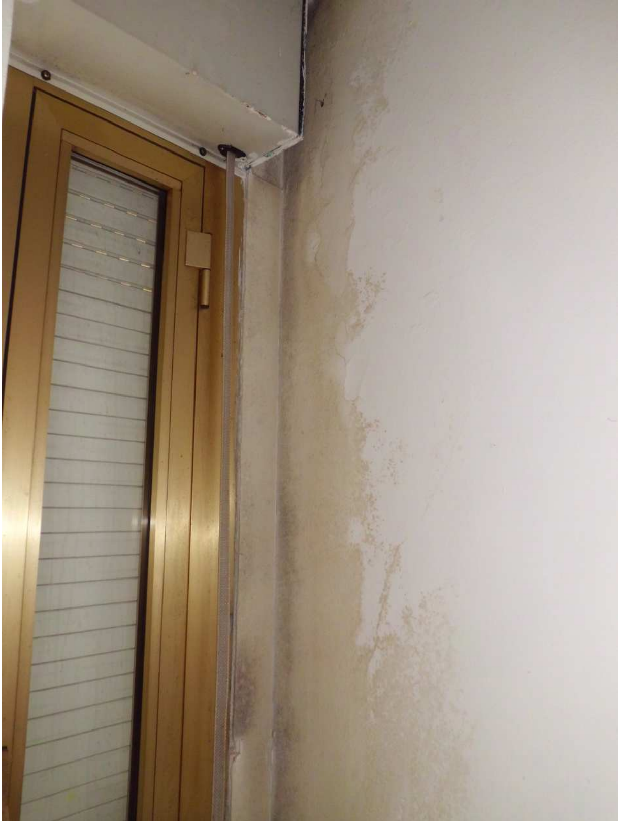
Foto n° 10 - 14/03/2019 - Comune di Maniago, foglio 20, part. 474, sub.67 – Camera matrimoniale posta all'angolo sud dell'appartamento. Particolare delle pareti.
