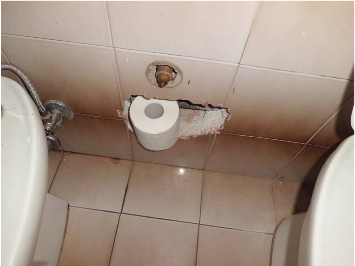
Foto n° 17 - 14/03/2019 - Comune di Maniago, foglio 20, part. 474, sub.67 – Bagno principale. Particolare della parete.
