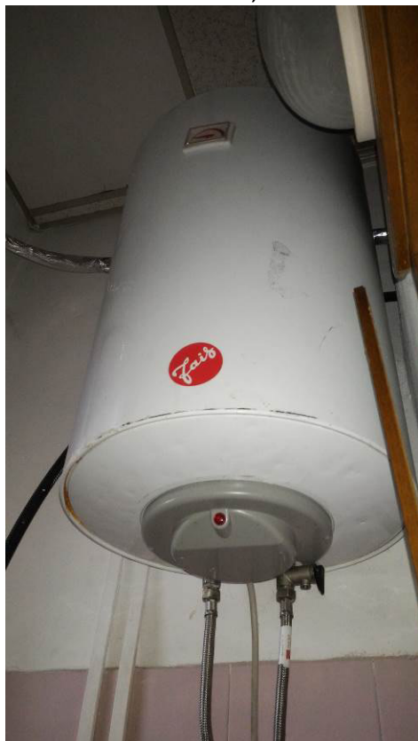
FOTO 14: BRESSO, VIA LILLO DEL DUCA 23, boiler elettrico nel bagno piccolo
