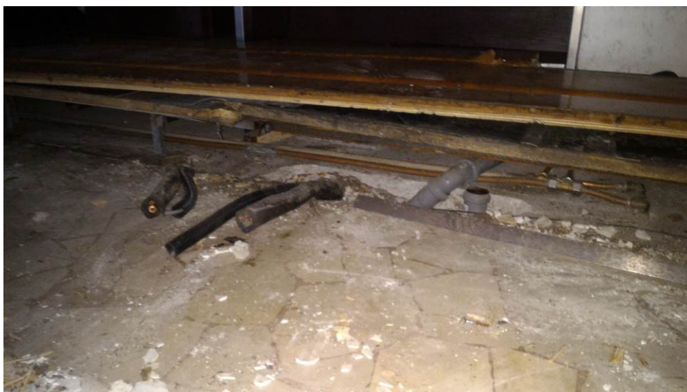
FOTO 18: BRESCO, VIA LILLO DEL DUCA 23, locale principale stato impianti
