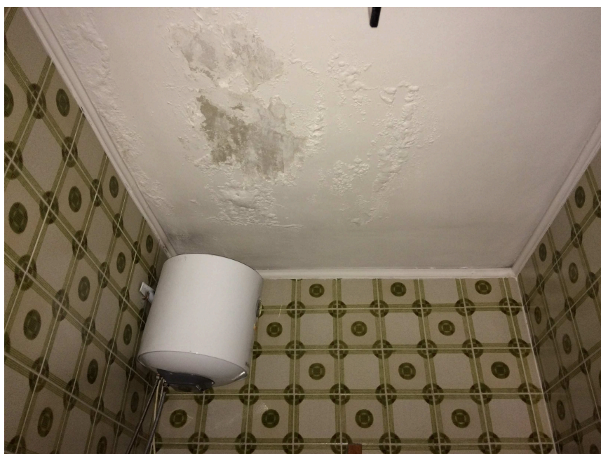
Foto n. 61: • Particolare della foto n. 60 (macchia a soffitto nel bagno).
