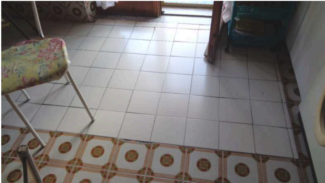
Foto n. 58: • Lesioni pavimento cucina.
