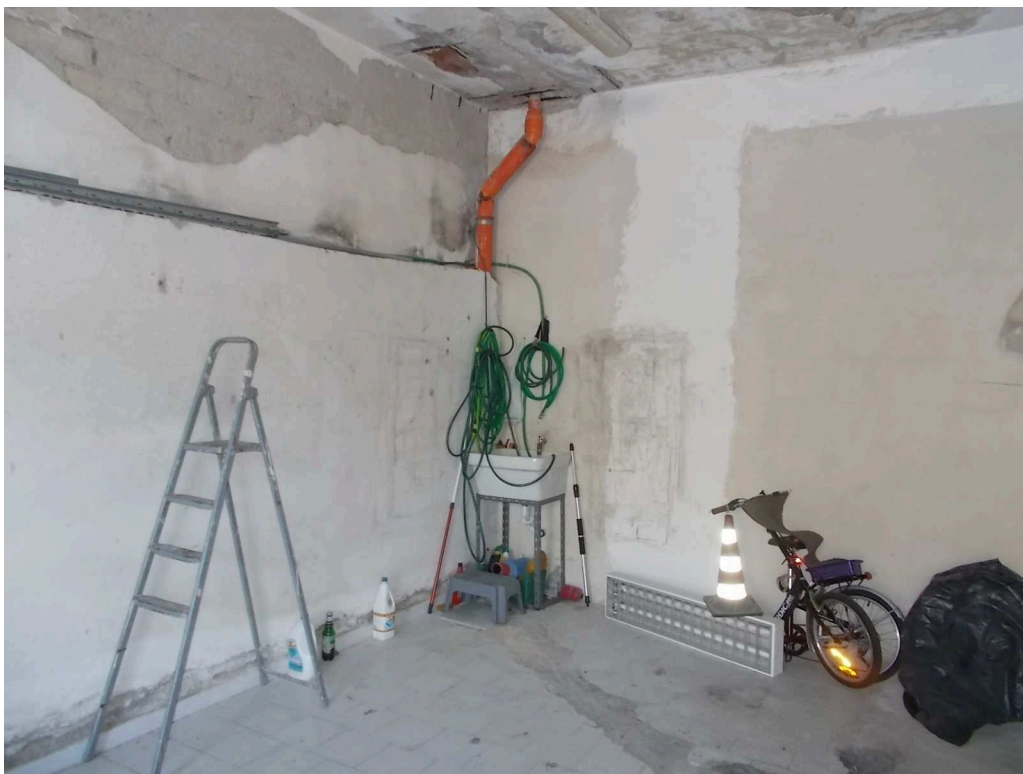
Foto n. 33: • Particolare della foto n. 32 (il locale-deposito è servito dall'impianto idrico).
