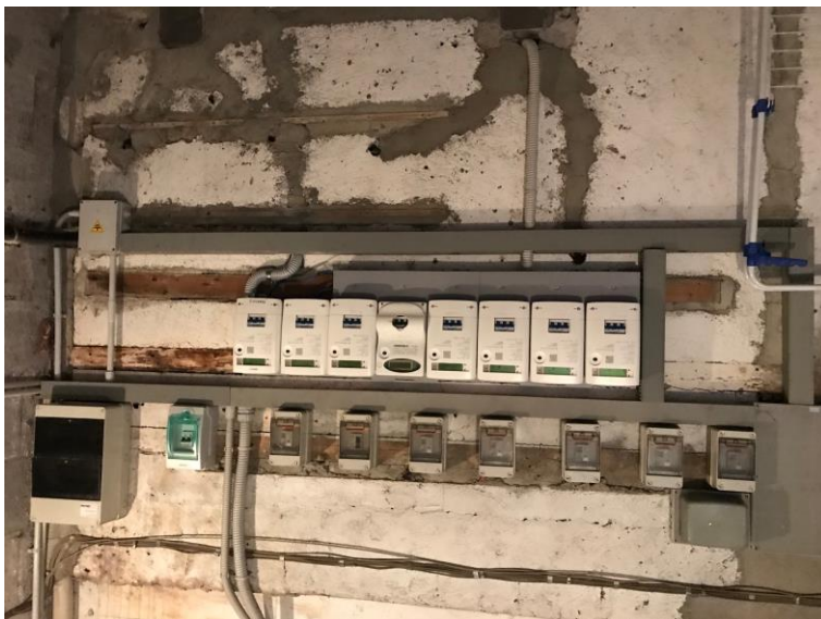
Immagine 10. Dettaglio della collocazione dei contatori elettrici, nel sottoscala al piano interrato.
