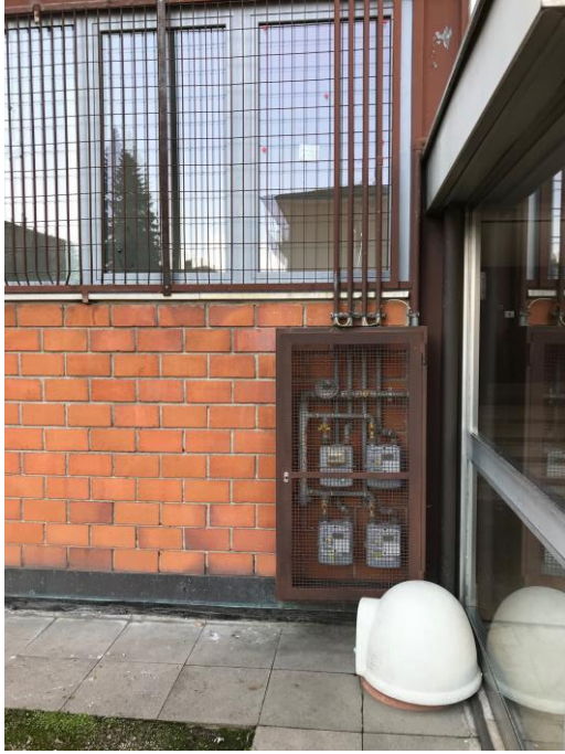
Immagine 5. Dettaglio della posizione dei contatori del gas, all'esterno del fabbricato.
