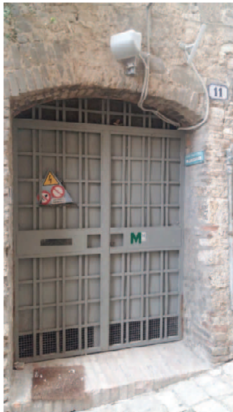
FOTO 8 – INGRESSO VIA DELLA PINCIANA N. 11 – CABINA ENEL
