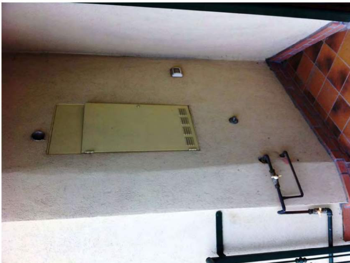
caldaia esterna subalterno 13
