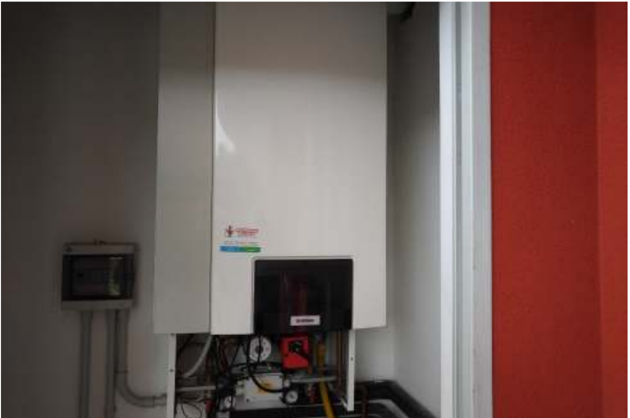
Foto n. 34 – Gruppo termico Ecoflam.
