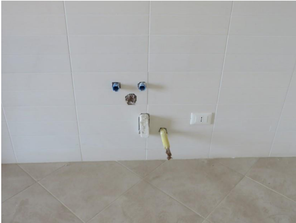
FOTO 31: PARTICOLARE IMPIANTI (Subalterno n. 13 – 3°P.)
