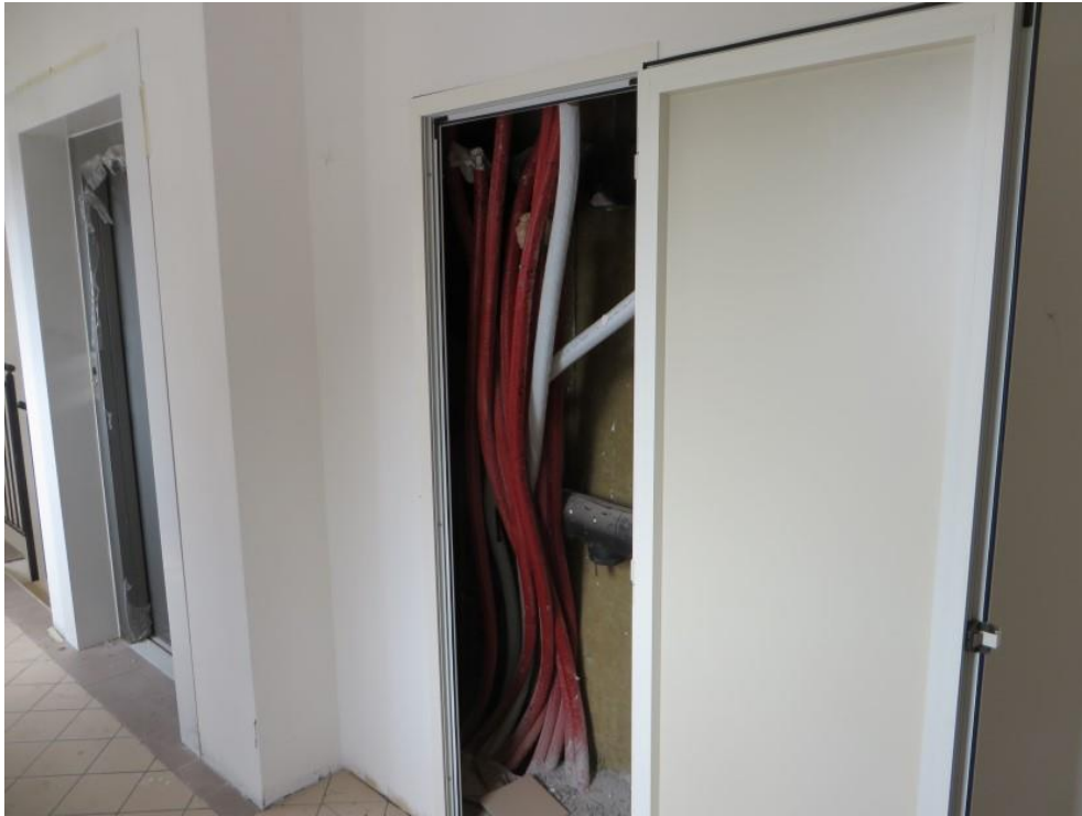
FOTO 41: PARTICOLARE IMPIANTI DEL CONDOMINIO
