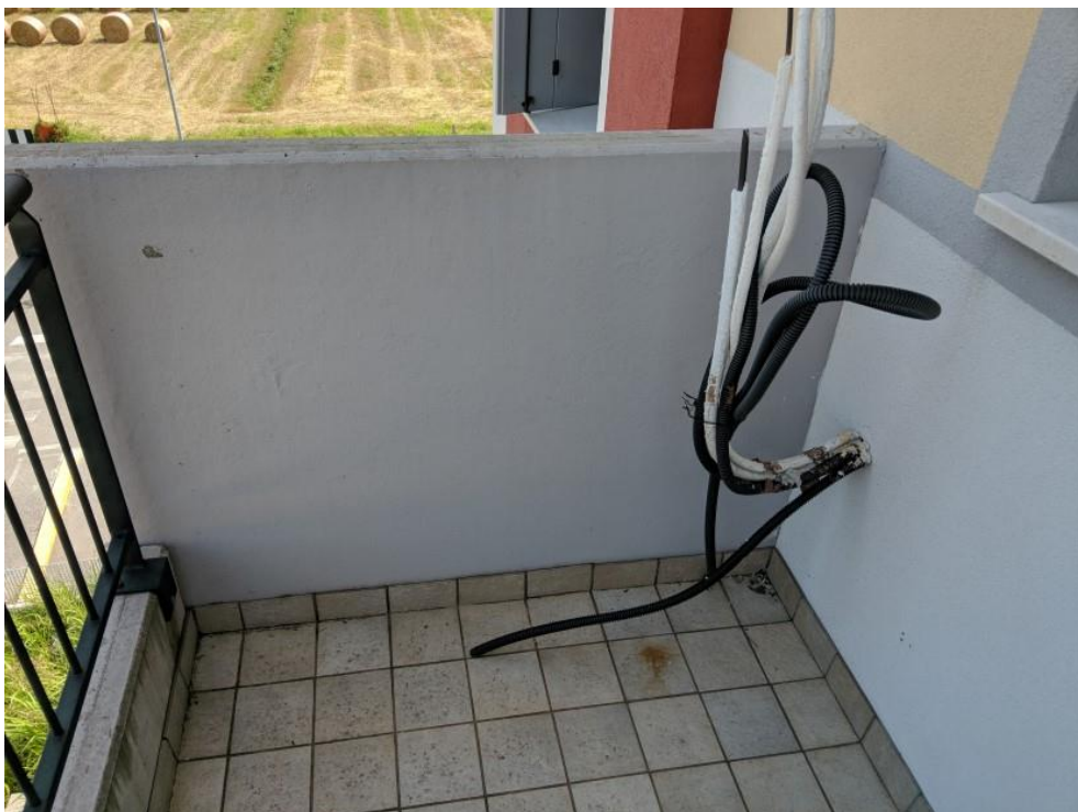
FOTO 32: PARTICOLARE IMPIANTI (Subalterno n. 13 – 3°P.)
