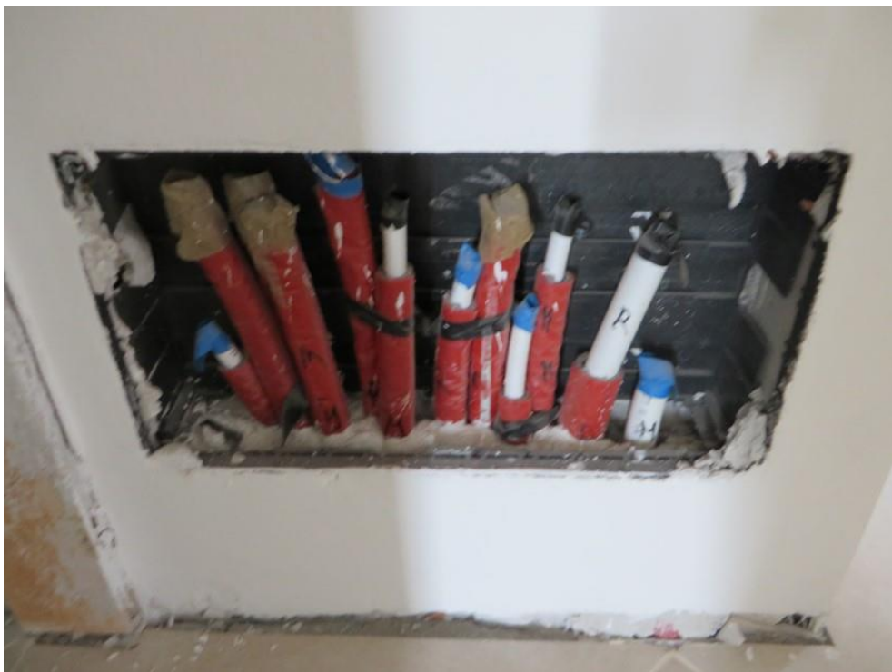
FOTO 28: PARTICOLARE IMPIANTI (Subalterno n. 13 – 3°P.)
