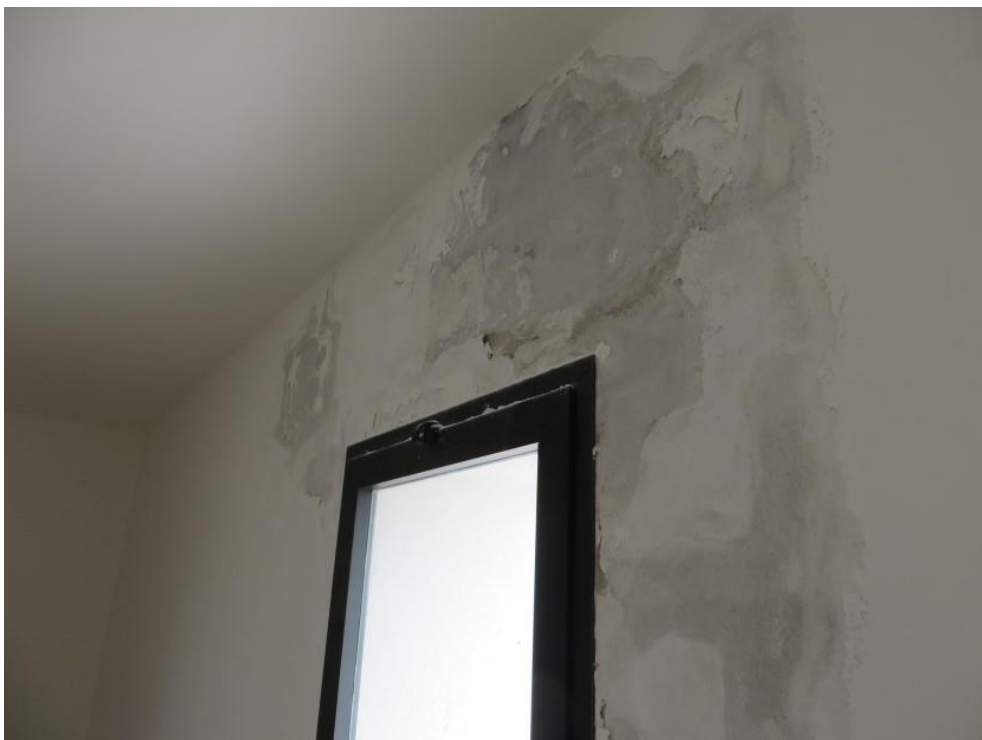
FOTO 40: PARTICOLARE INFILTRAZIONI DEL CONDOMINIO
