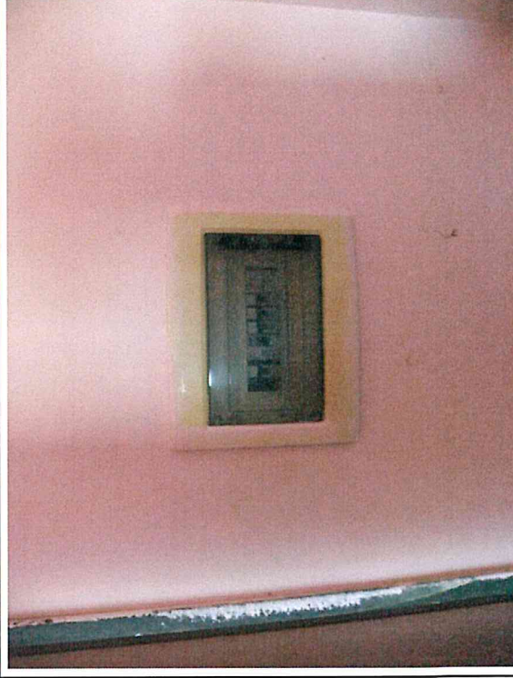
Unità immobiliare oggetto di stima: particolare quadri elettrici
