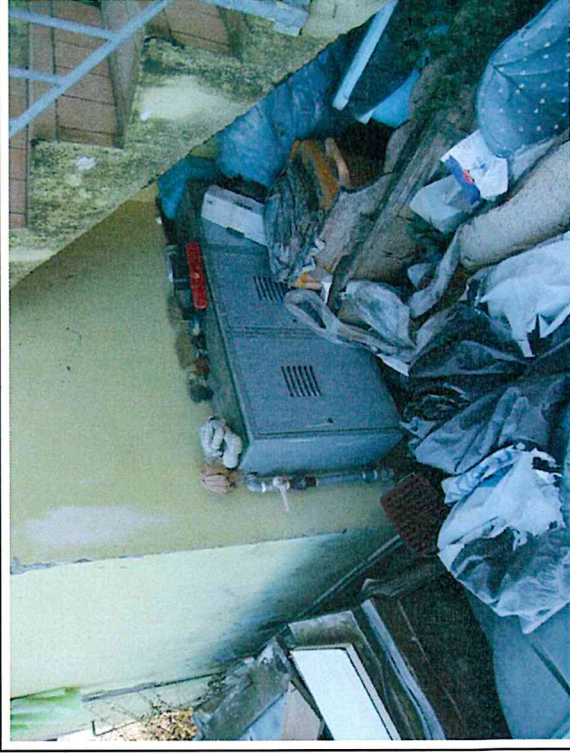
Unità immobiliare oggetto di stima: impianto gas metano
