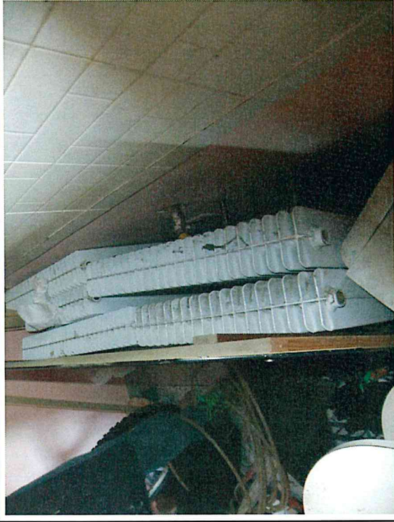
Unità immobiliare oggetto di stima: particolare impianto riscaldamento
