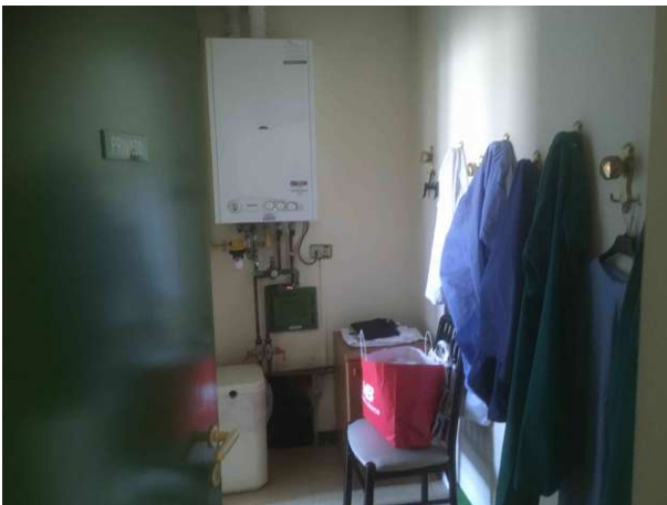
Veduta caldaia (sub 13)
