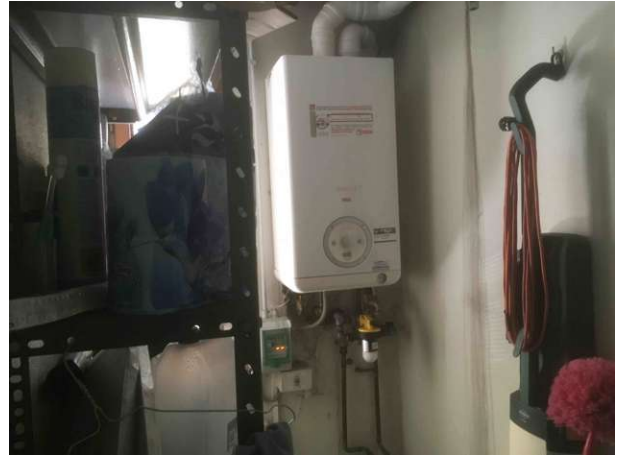
Veduta caldaia (sub 12)
