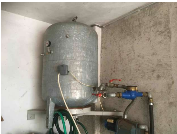
Particolare autoclave (sub 11)
