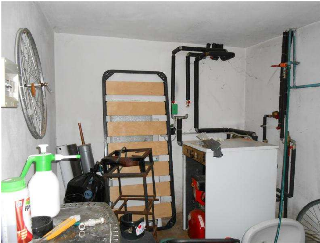
19) Locale centrale termica
