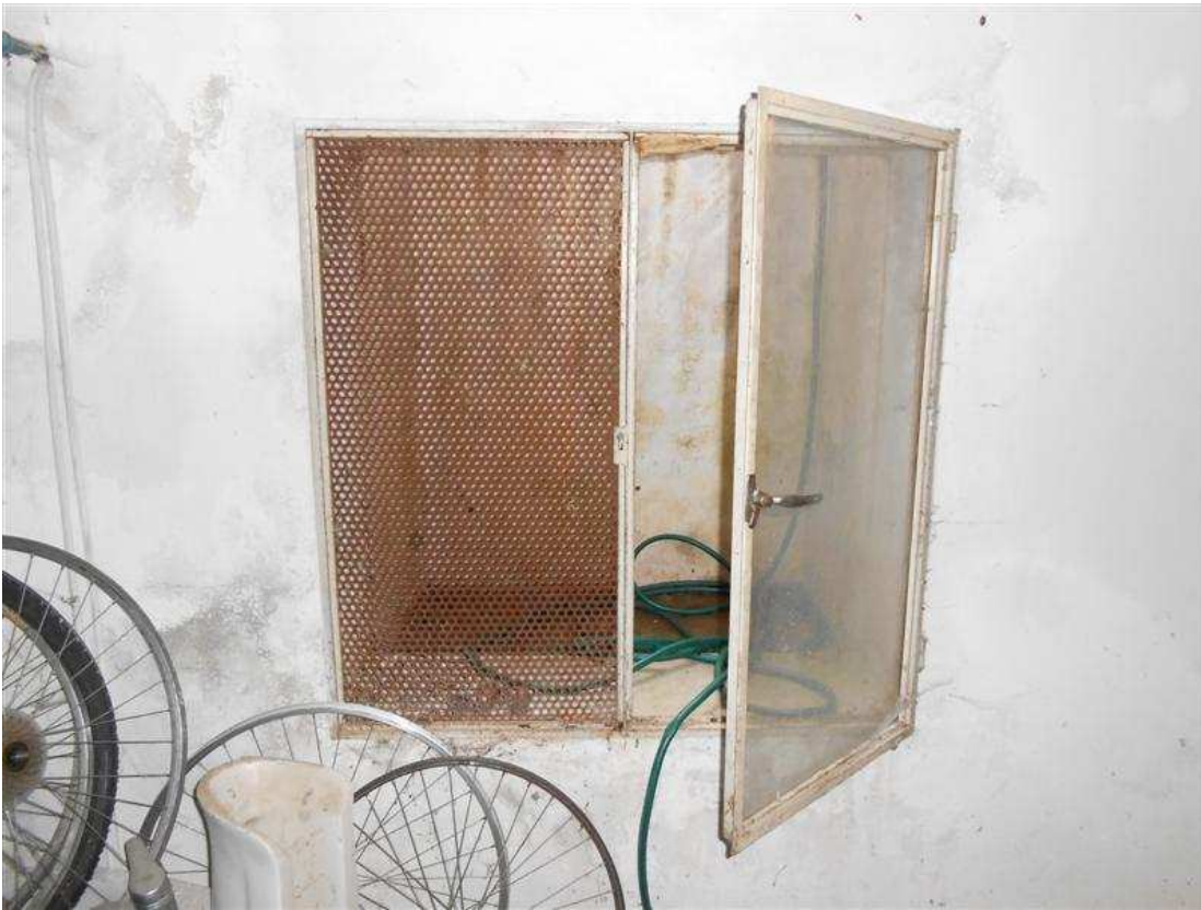
21) Particolari del locale centrale termica
