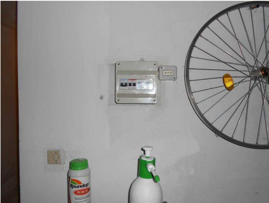
23) Particolari del locale centrale termica
