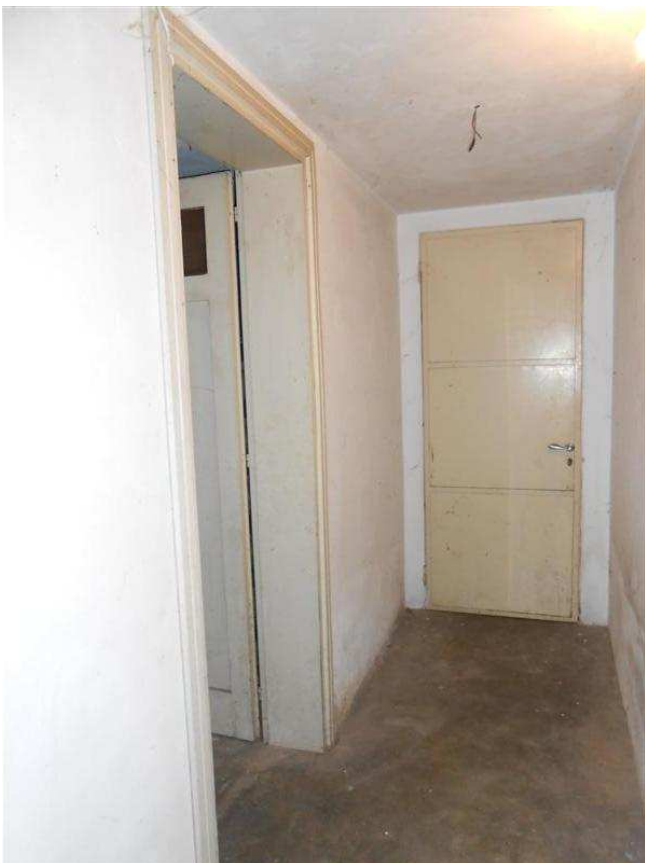
16) Porta di ingresso al locale centrale termica (di fronte)
