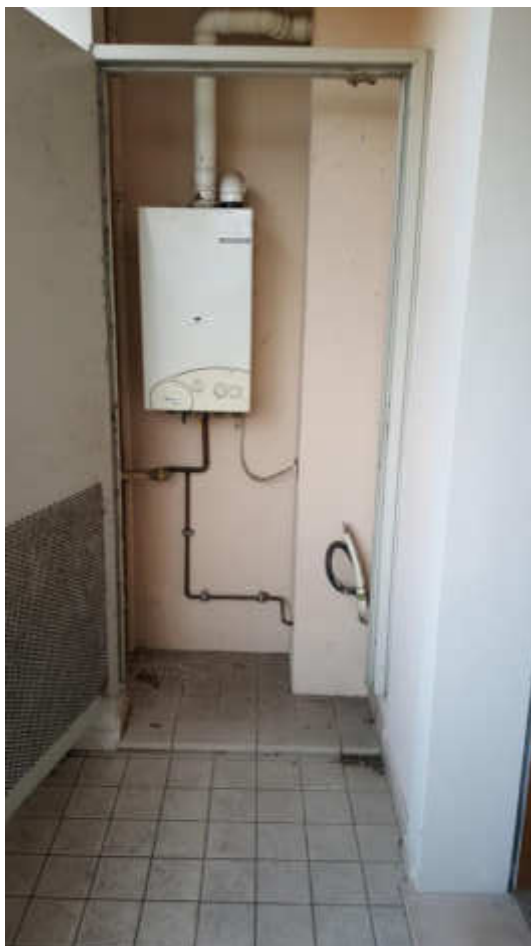
Vano caldaia sub 14
