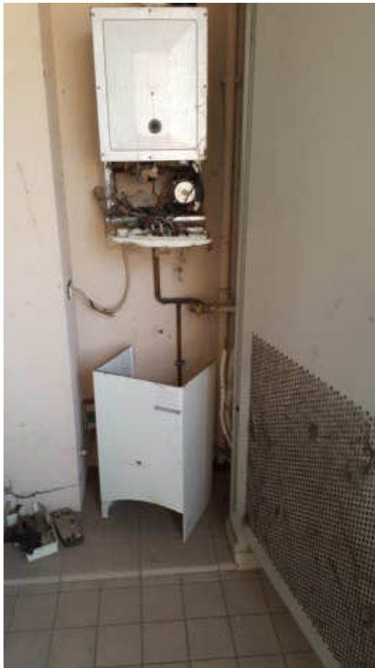
Vano caldaia sub 17
