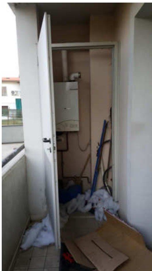
VANO CALDAIA SUB 5
