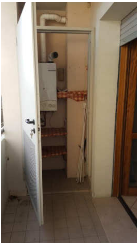
VANO CALDAIA SUB 11
