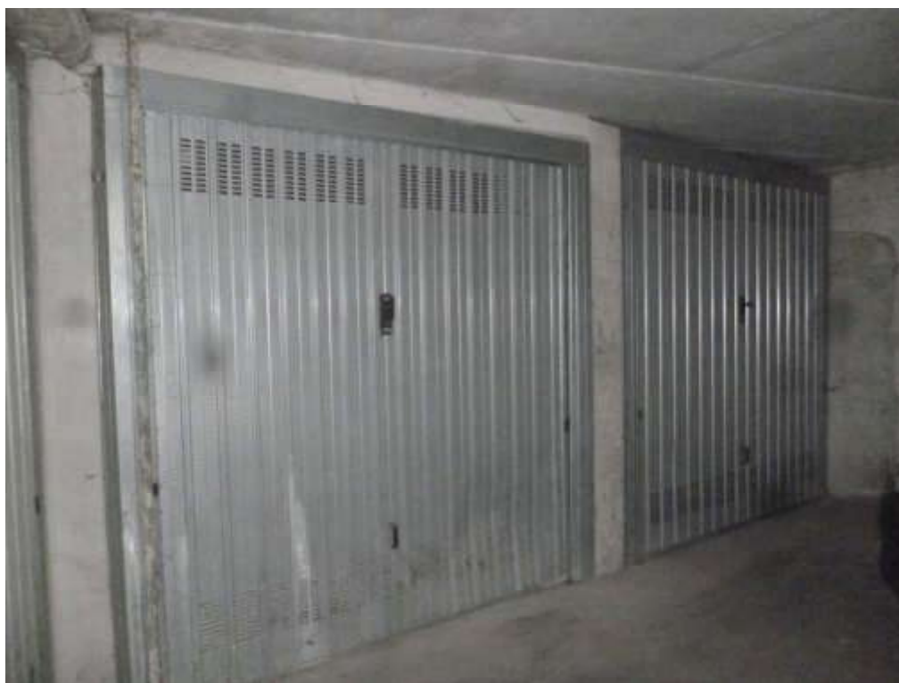
FOTO 16 - Box Sub. 24 a sinistra e Box Sub. 25 a destra. La basculante del Sub. 24 è bloccata dal tamponamento interno.
