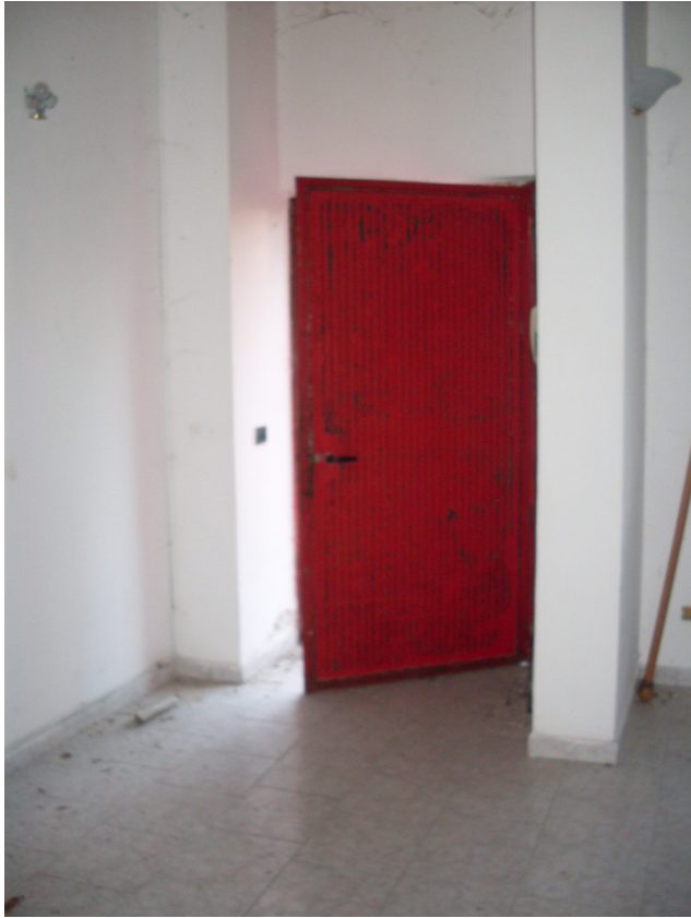
INGRESSO SUB 708 P. T.
