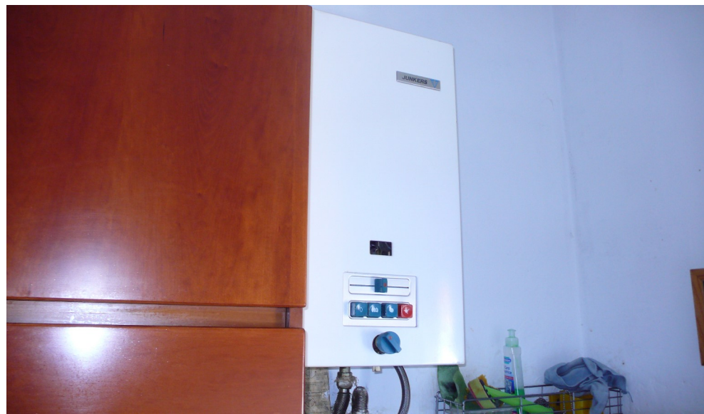
Vista 14 - generatore ACQUA CALDA
