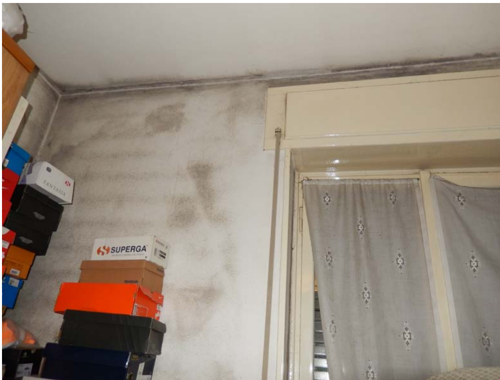
FOTO 20: Interno dell'unità pignorata – Vista di dettaglio dei ponti termici presenti nella camera 2 (così come in altre zone dell'appartamento).
