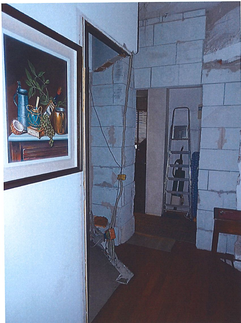
Foto 17 – Altra vista della del muro del corridoio.
