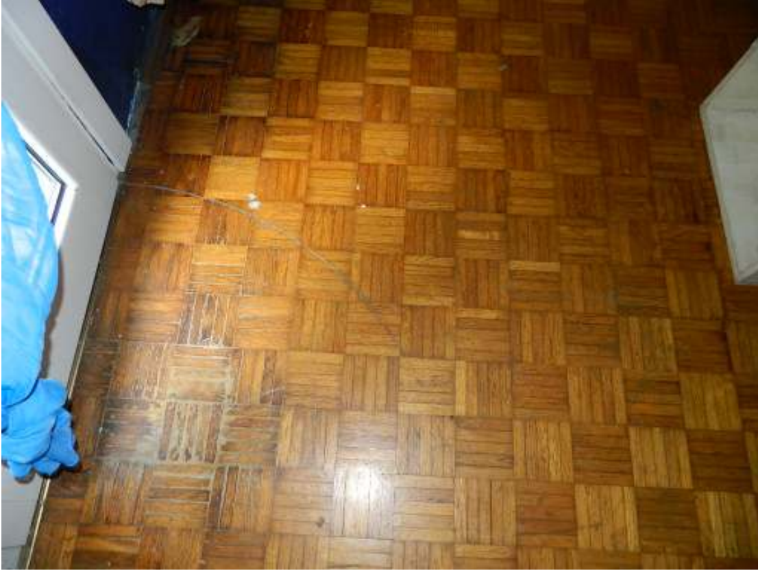
Foto n. 45 – Degrado alla pavimentazione in parquette delle camere.
