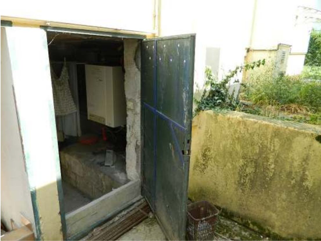
Foto n. 37– Accesso centrale termica – bene comune non censibile.
