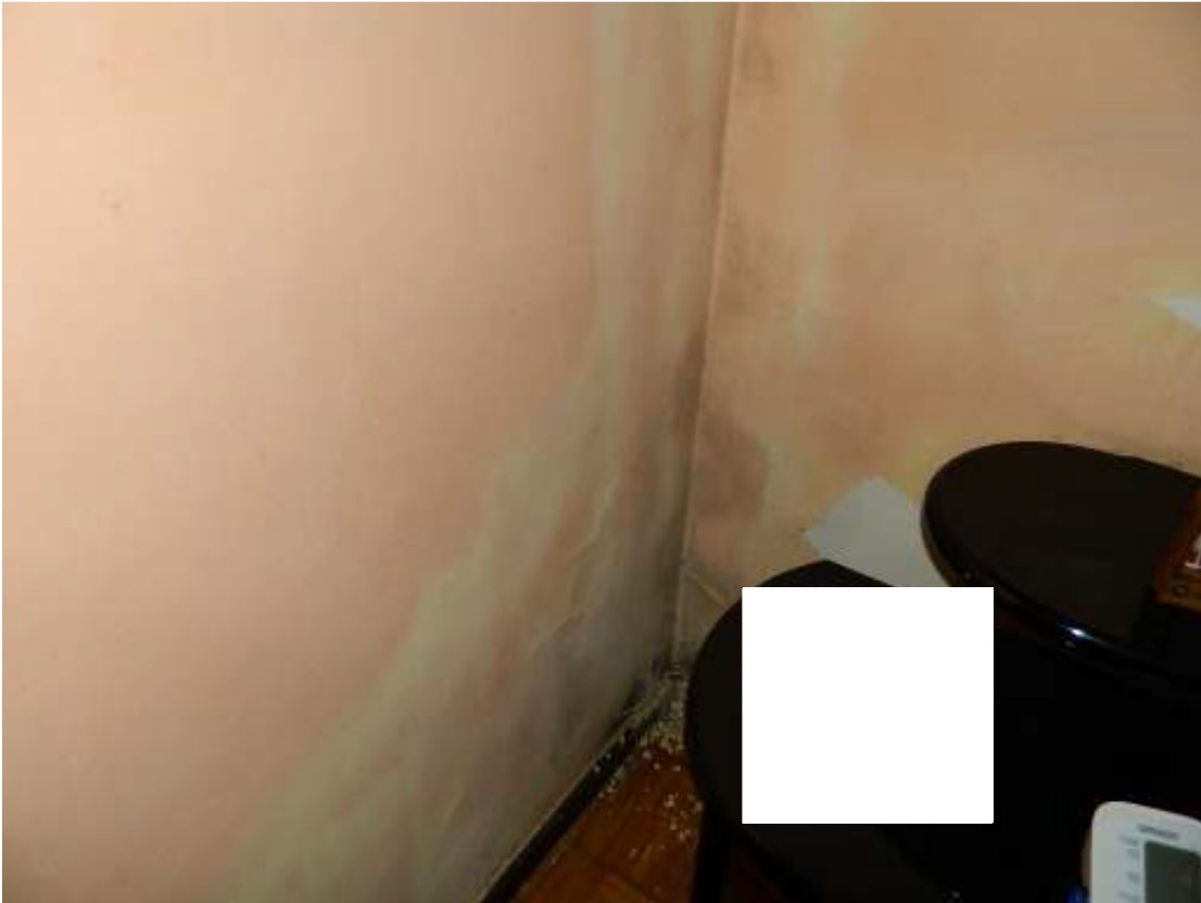
Foto n. 43 – Degradamento ad intonaci e tinte di pareti.
