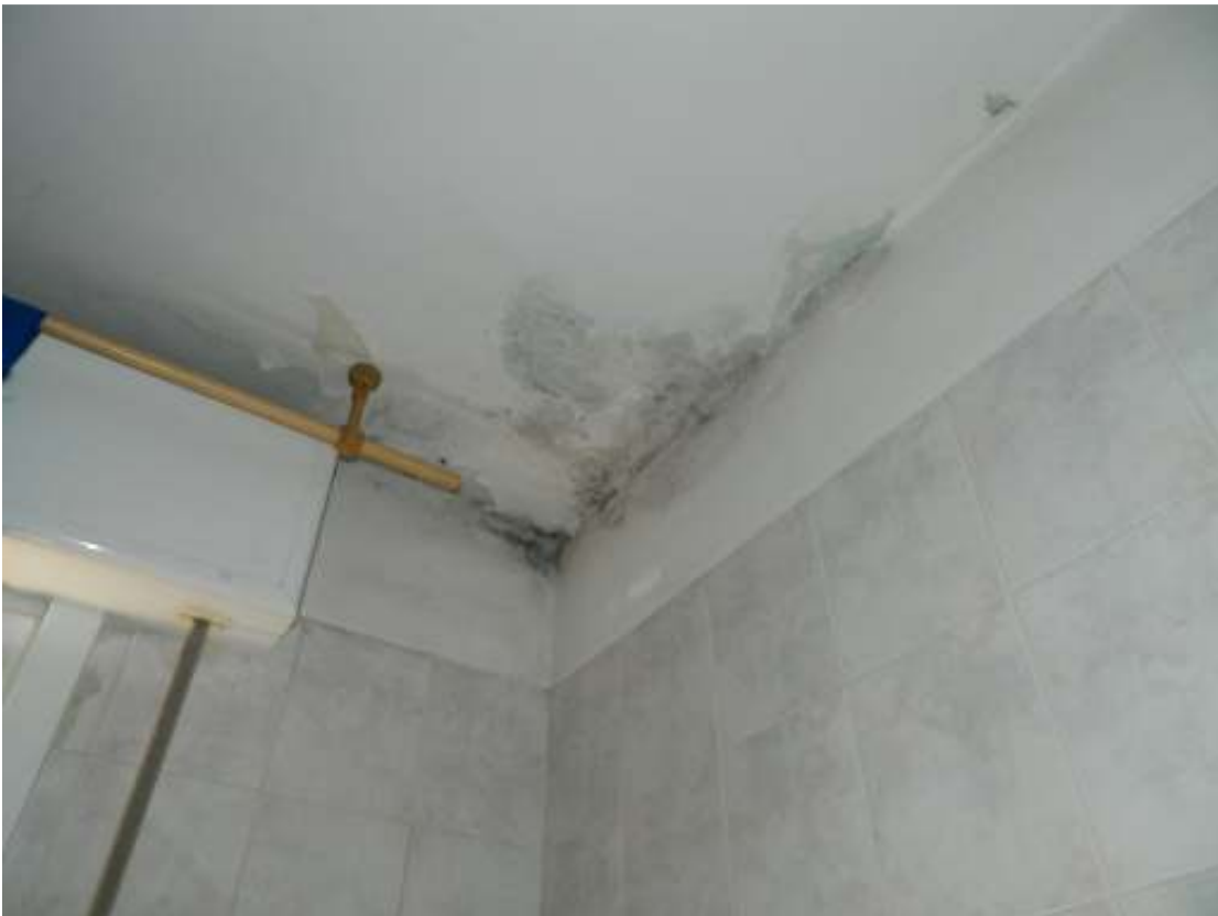
Foto n. 42 – Degrado ad intonaci e tinte del soffitto del bagno.
