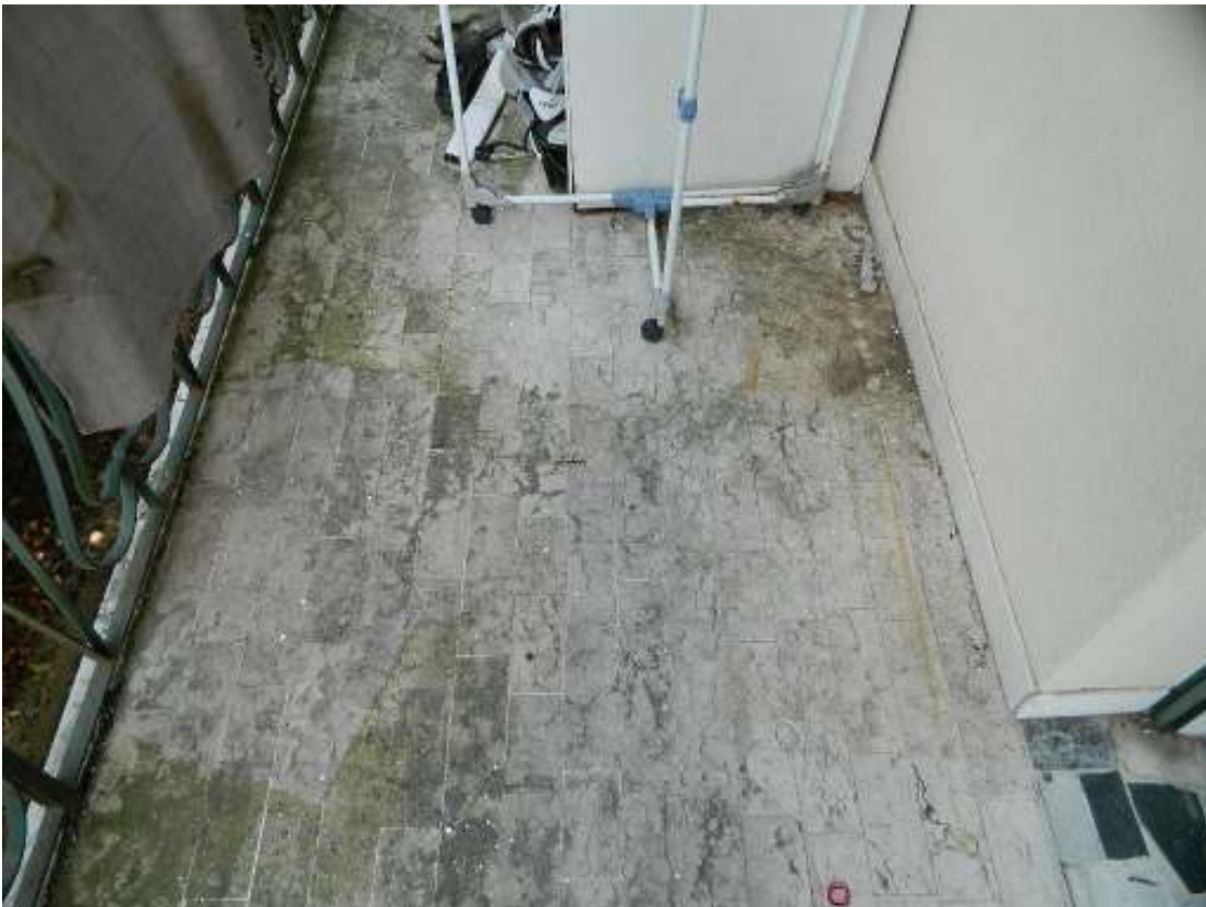
Foto n. 44 – Degradamento al rivestimento della pavimentazione dei terrazzini.
