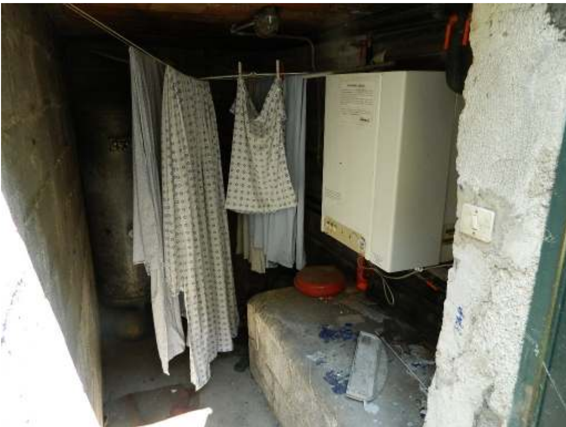
Foto n. 38 – Centrale termica: in evidenza gruppo termico Ferrol e vaso di espansione dell' autoclave.
