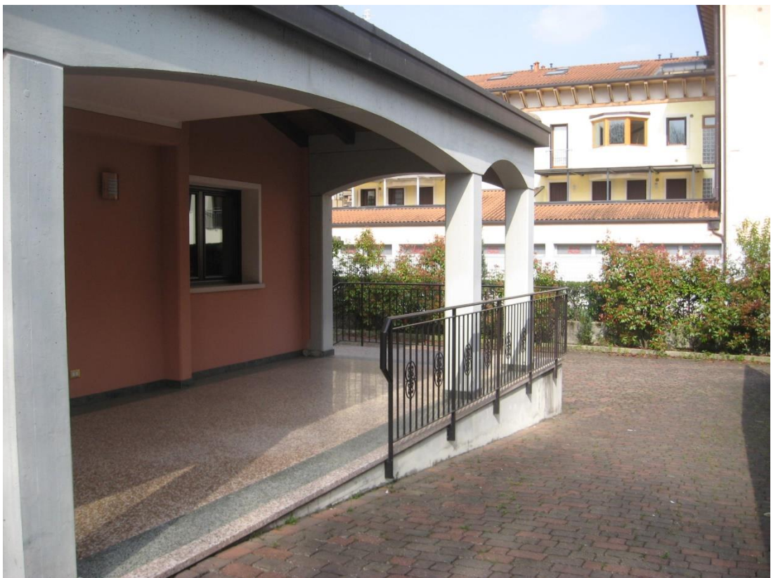
Il porticato a lato sud – su nota la rampa di raccordo al piano autorimessa
