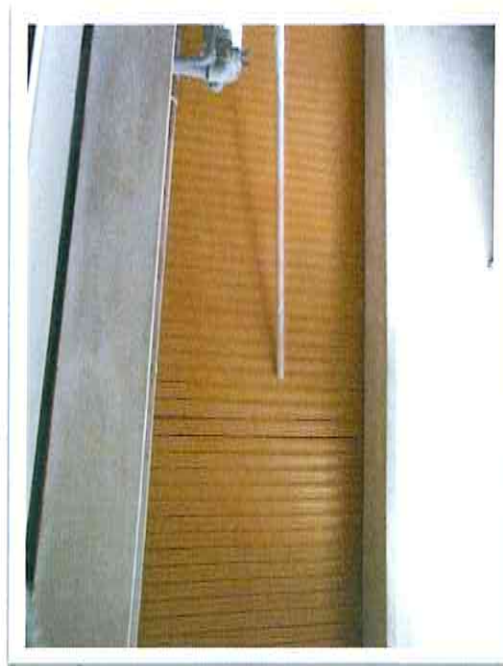
Foto 12 porta finestra chiusa dall'interno
