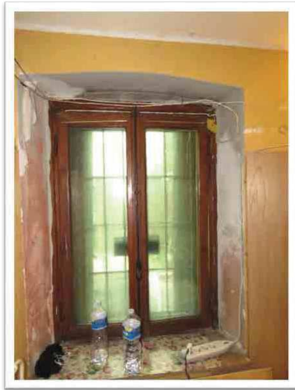
Finestra della camera e pericolosità cavi elettrici.
