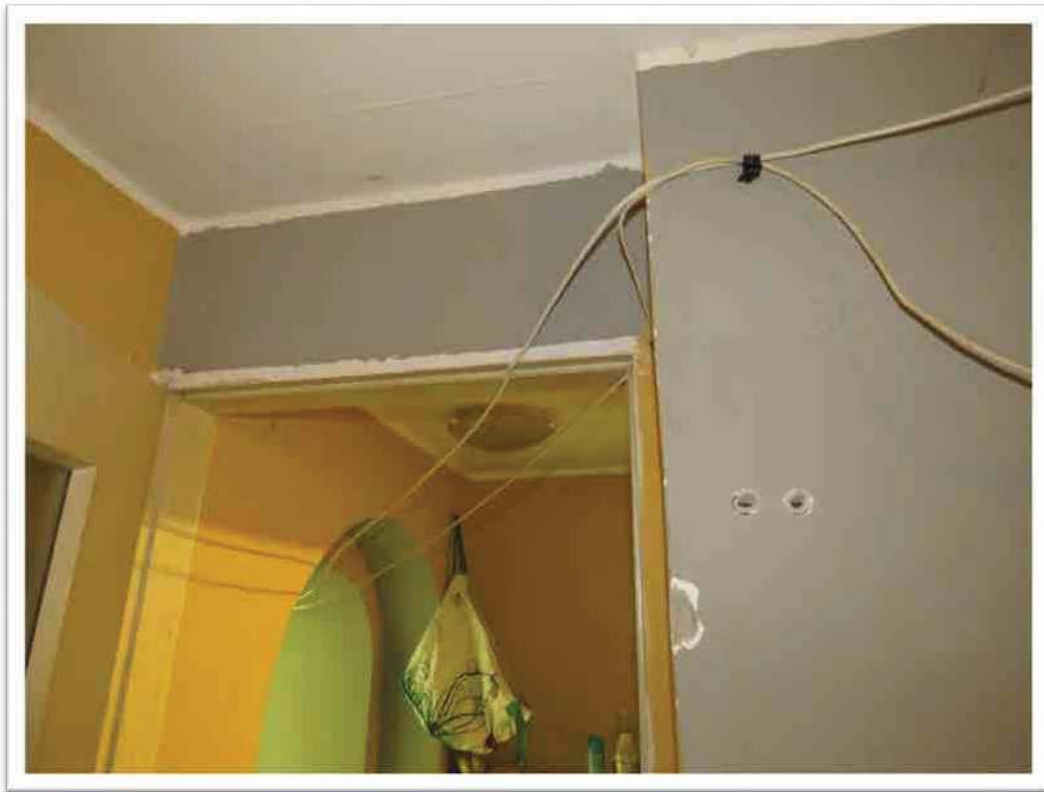
Pericolosità cavi elettrici e vista del prospetto del retro da cortile di proprietà di terzi.
