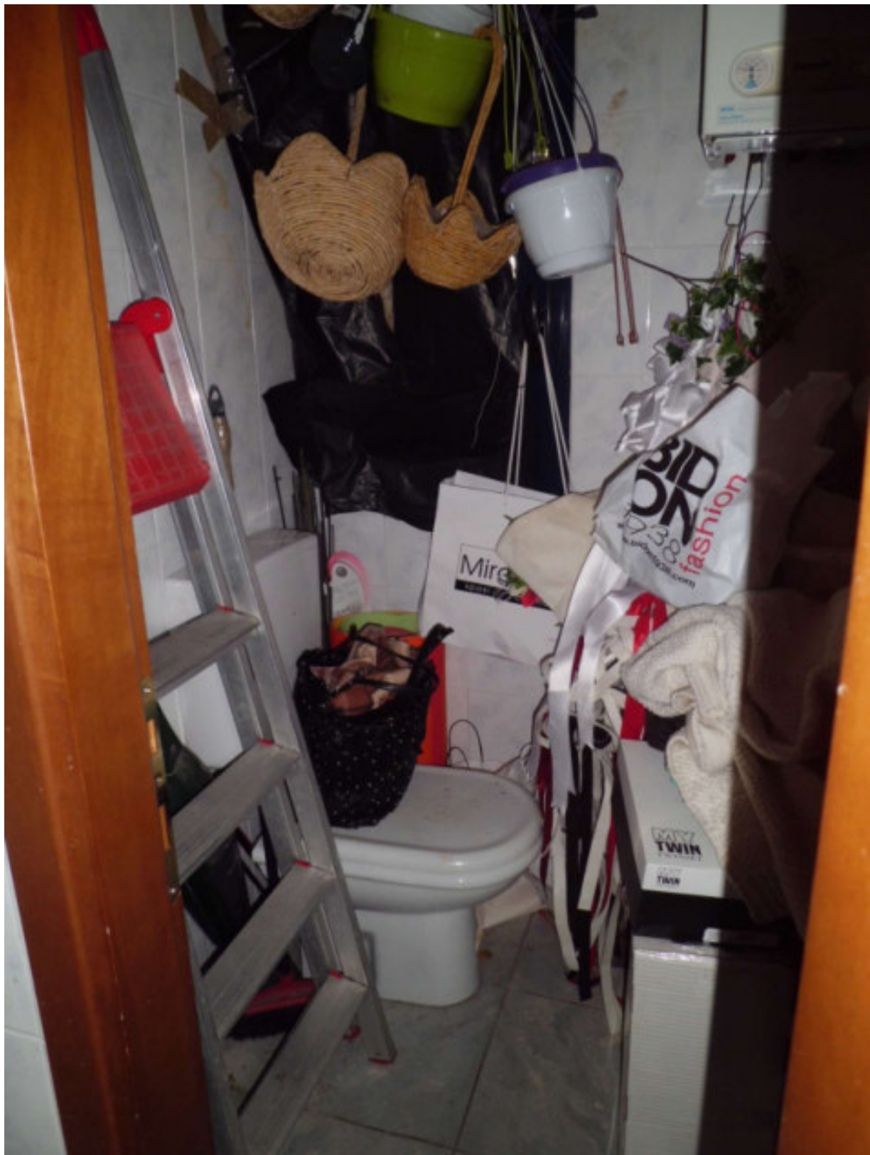
Foto n° 10 - 21/11/2017 - Comune di San Michele al Tagliamento, foglio 24, part. 1114, sub. 3 - Stanza catastalmente identificata come bagno. Vi è la presenza del solo water e della caldaia.
