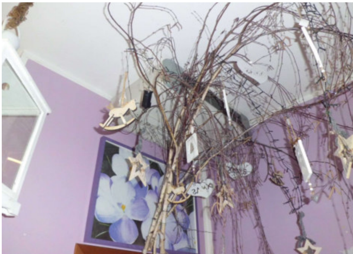
Foto n° 6 - 21/11/2017 - Comune di San Michele al Tagliamento, foglio 24, part. 1114,sub. 3 - Particolare dell'impianto di climatizzazione posto sul soffitto della stanza principale.
