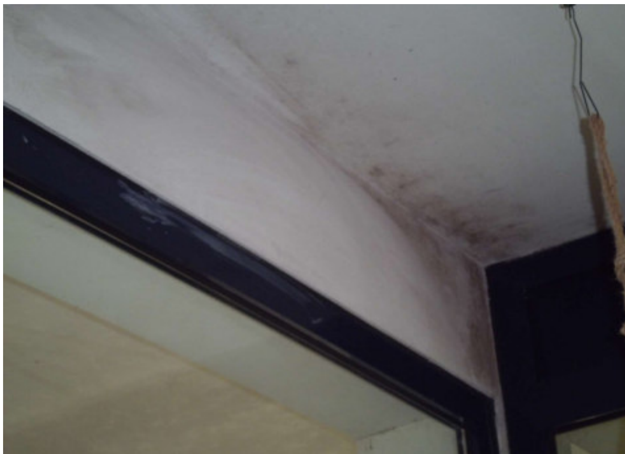
Foto n° 7 - 21/11/2017 - Comune di San Michele al Tagliamento, foglio 24, part. 1114, sub. 3 - Muffa sul soffitto del negozio.
