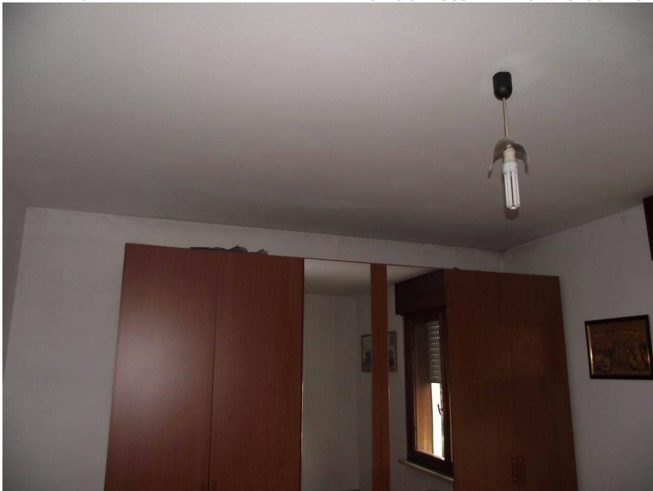
Foto 18 - camera matrimoniale: tracce di muffa
