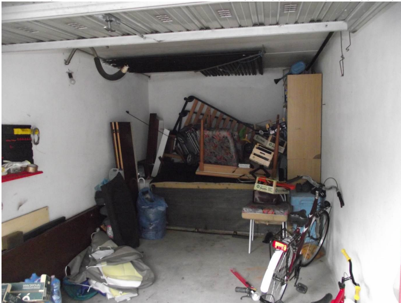
Foto 23 - autorimessa: in alto il passaggio dei tubi condominiali di riscaldamento.
