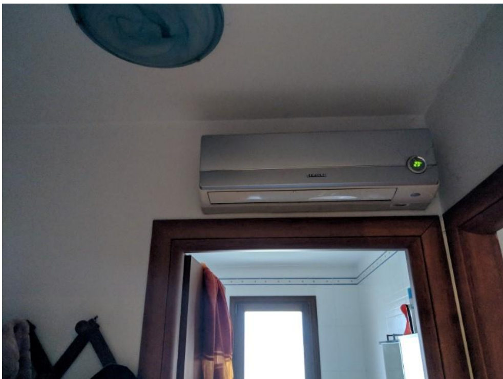
FOTO 26: UNITA' INTERNA CLIMATIZZATORE (Subalterno n. 1 – P.T.)
