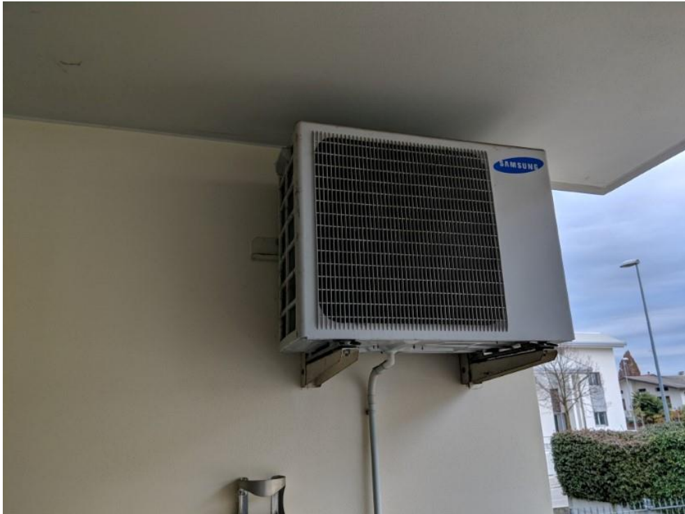
FOTO 27: UNITA' ESTERNA CLIMATIZZATORE (Subalterno n. 1 – P.T.)
