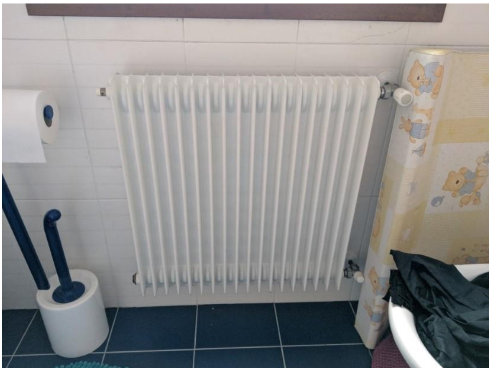
FOTO 28: PARTICOLARE RADIATORE (Subalterno n. 1 – P.T.)
