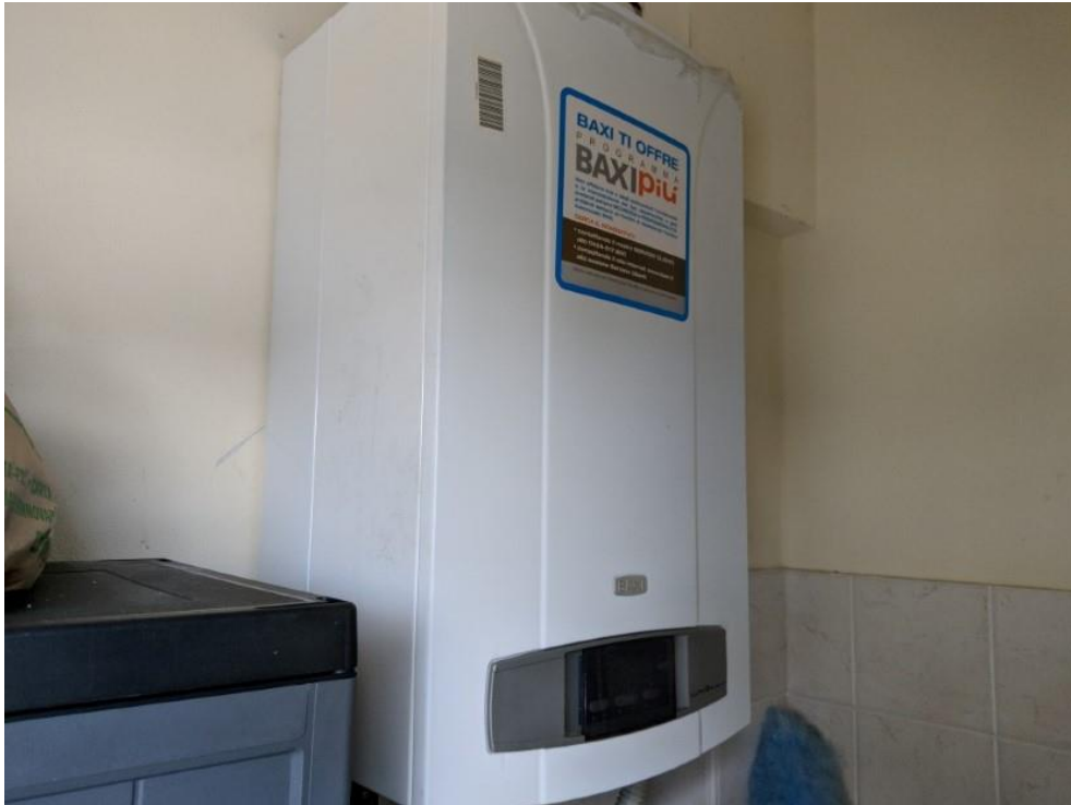
FOTO 15: CALDAIA (Subalterno n. 1 – P.T.)
