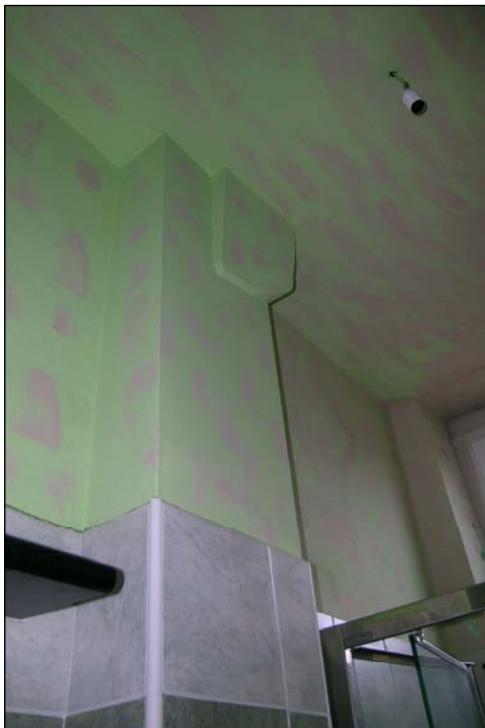
Foto 10 - Colonna di scarico bagno
