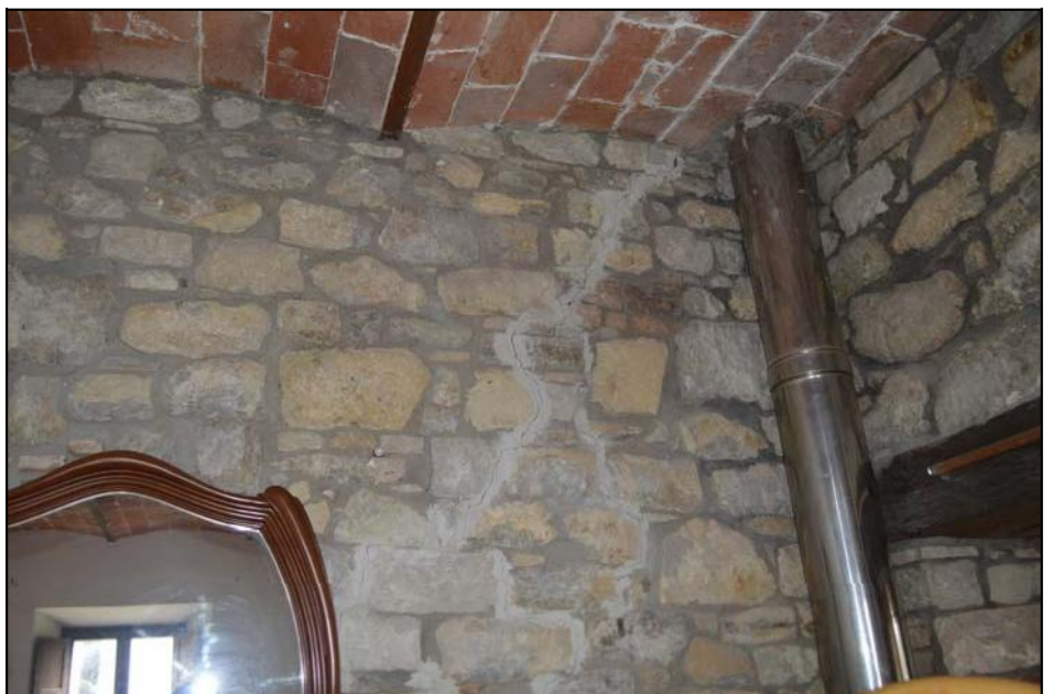
Foto n. 9, 10 – Lesione parete piano primo (31 gennaio 2019)
