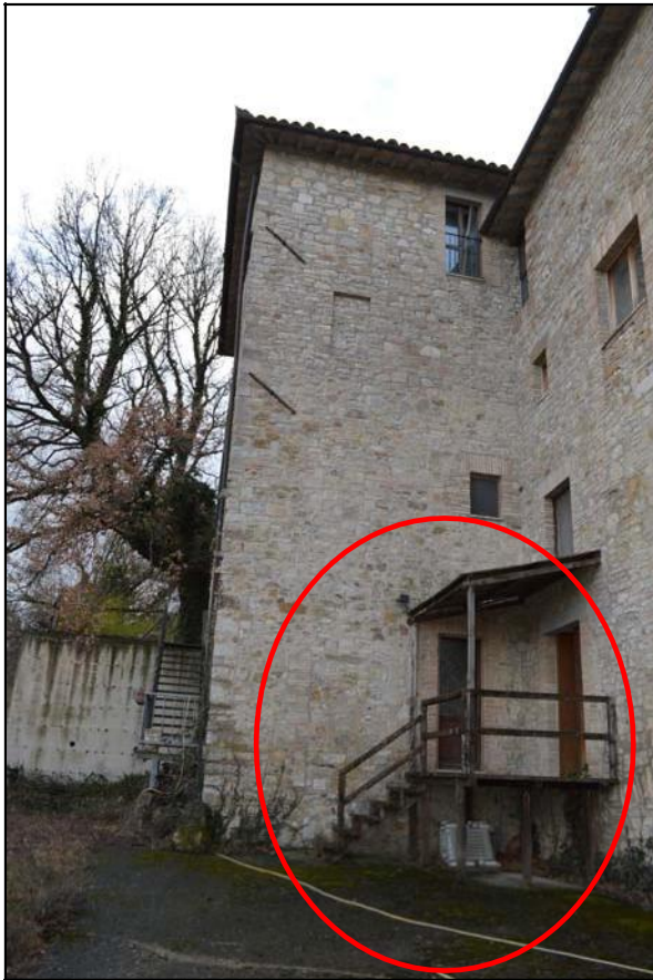
Foto n. 11 – Scala esterna in legno ammalorata
