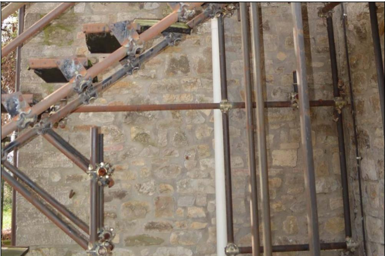
Foto n. 6 – Particolare della parete con evidenza dello stato di sofferenza in corrispondenza dello spigolo destro
