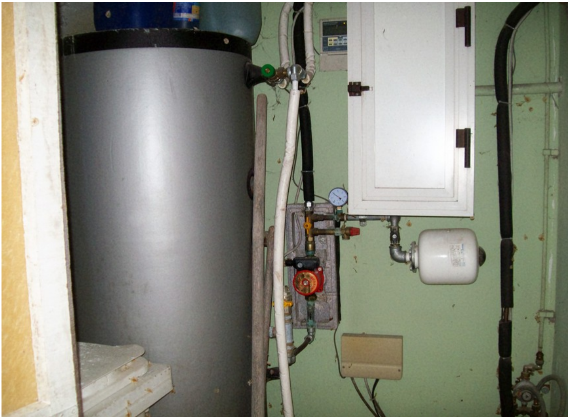
Foto 14: Bollitore vano tecnico piano seminterrato
