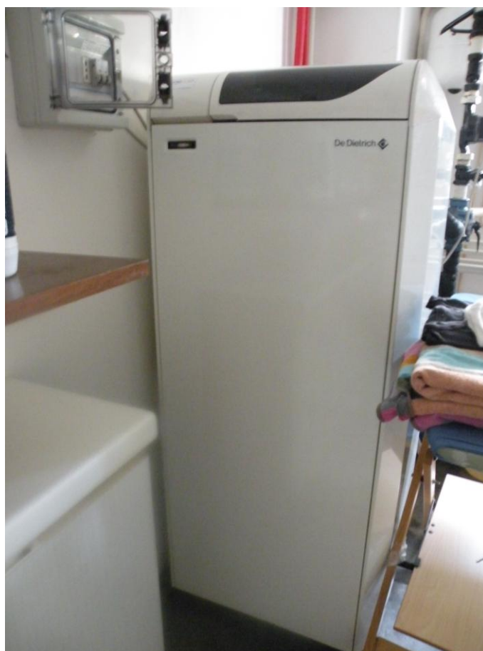
Foto 20 - Piano terra - Caldaia
