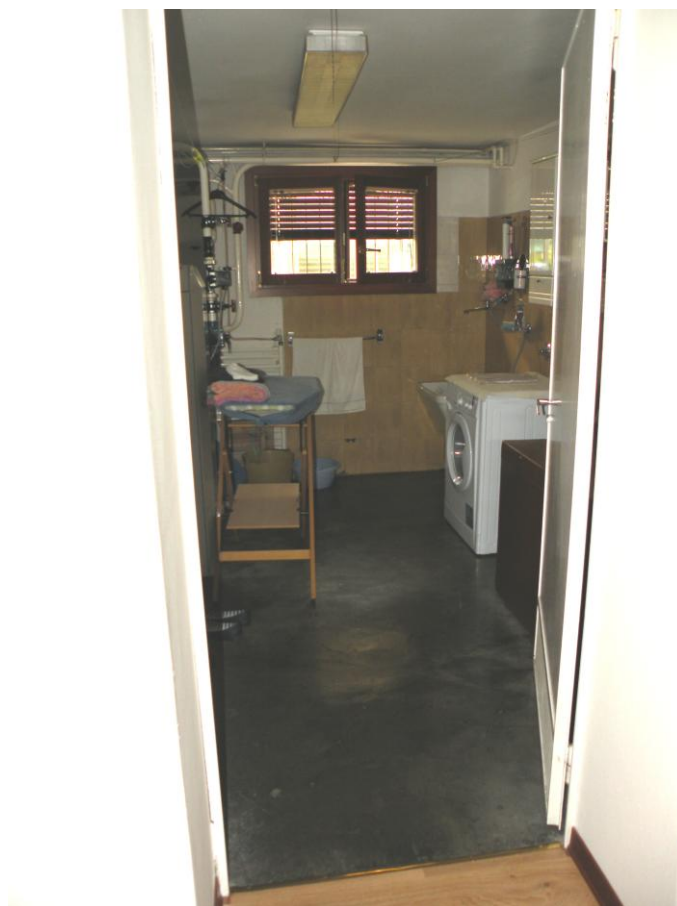
Foto 19 - Piano terra - Centrale termica
