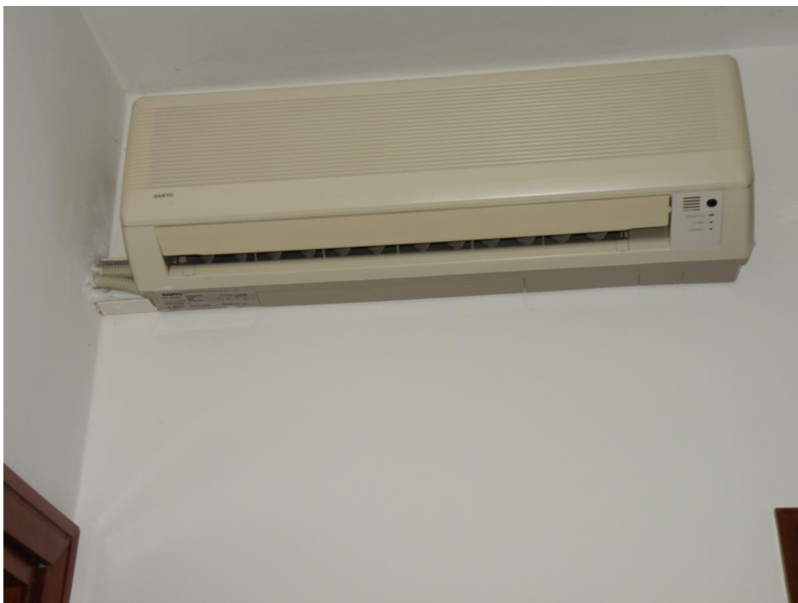
Foto 14 - Piano primo - Condizionatore
