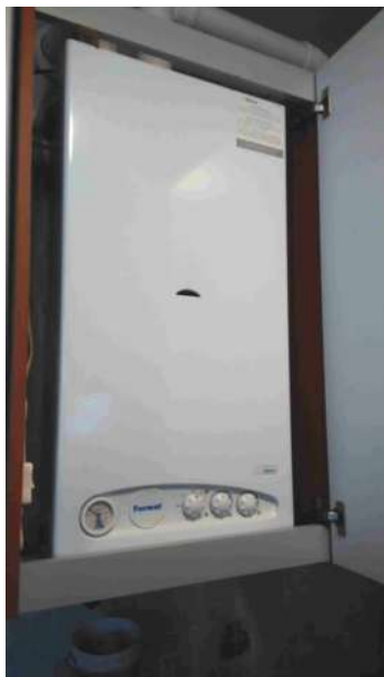
Particolare caldaia c/o Zona cottura
