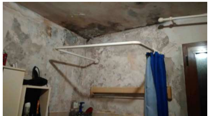
Particolare infiltrazione Bagno p. 1
