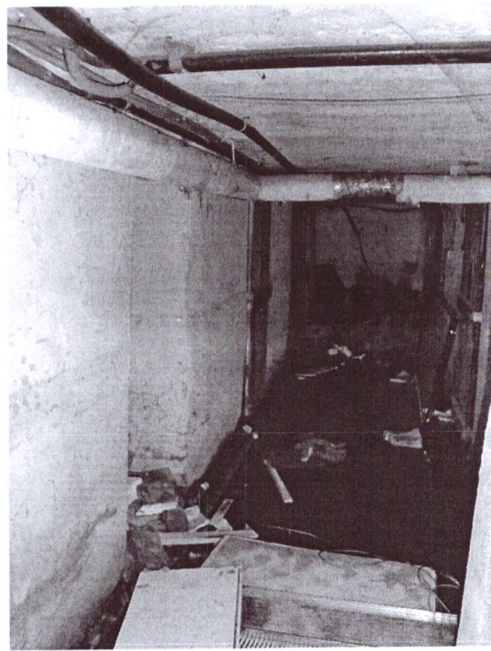
piano seminterrato /piano cantine (allagato)
