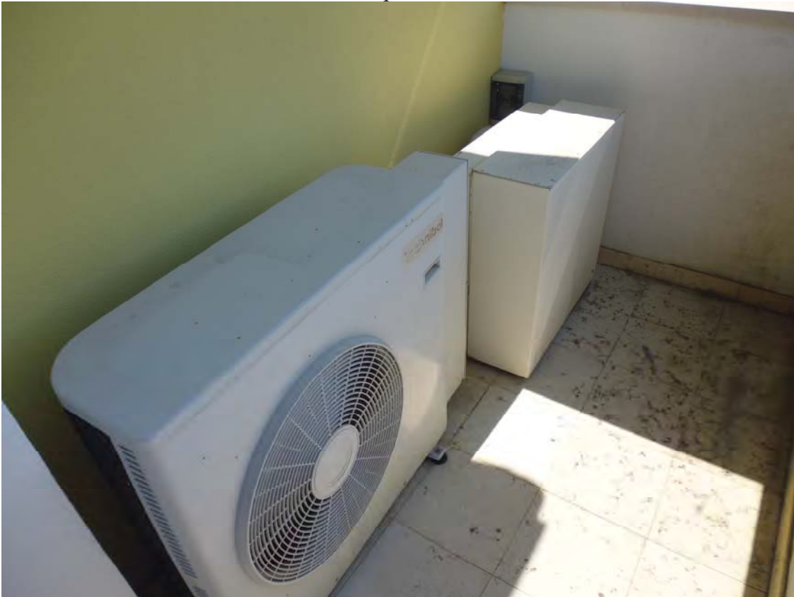
Particolare unità esterne condizionatore e pavimentazione in marmo dei terrazzi
