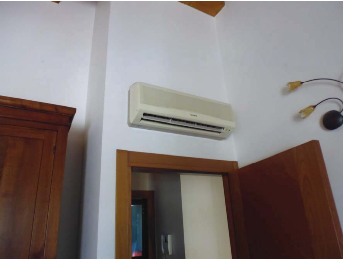
Particolare condizionatore nella camera matrimoniale
