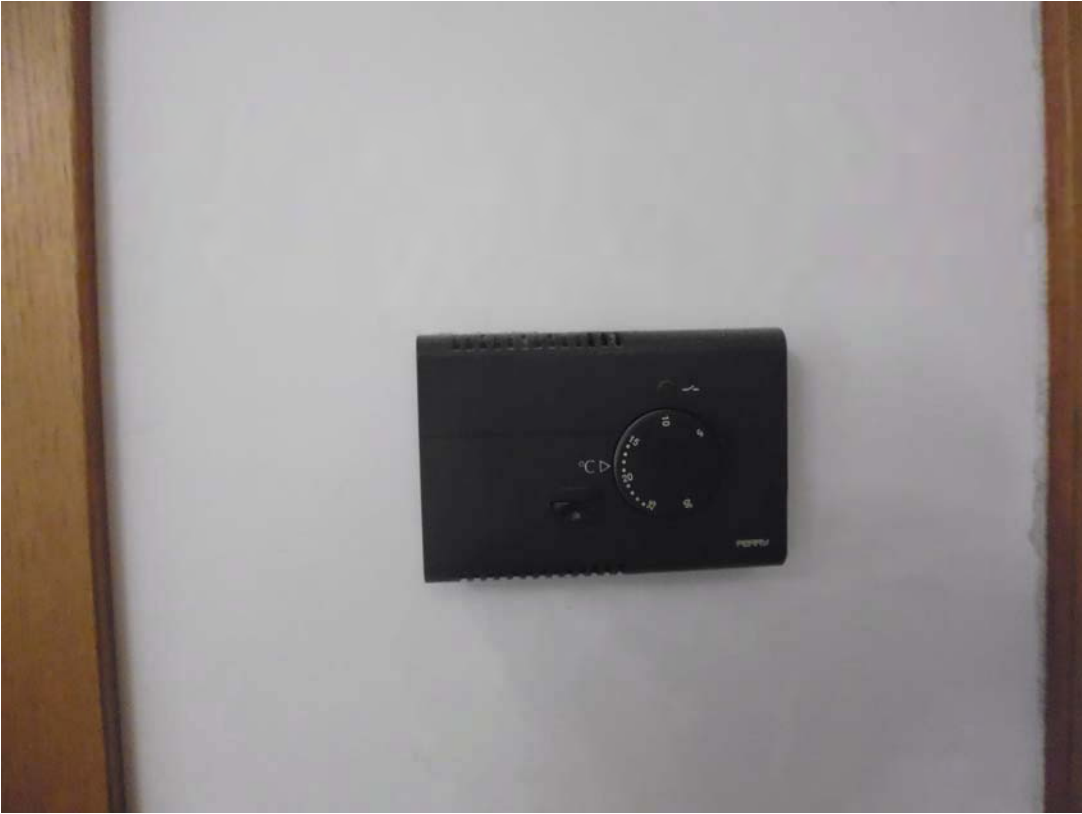
Particolare termostati ambiente
