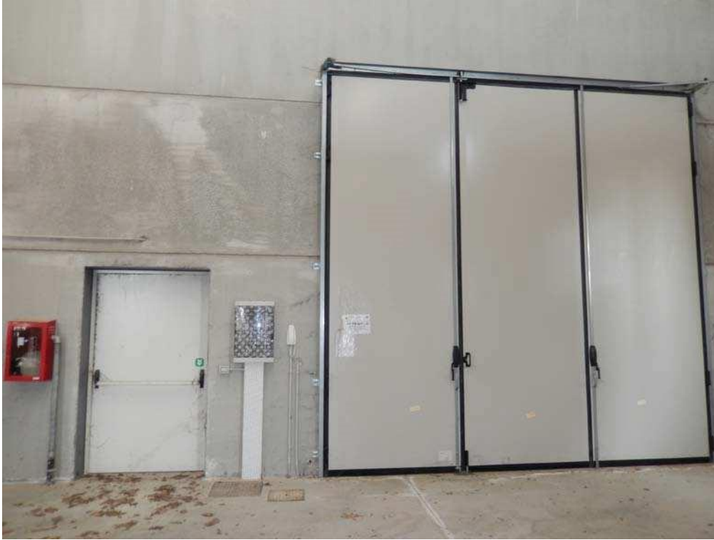
FOTO 12: Interno dell'unità pignorata – Vista di dettaglio di due dei quattro infissi d'ingresso.
