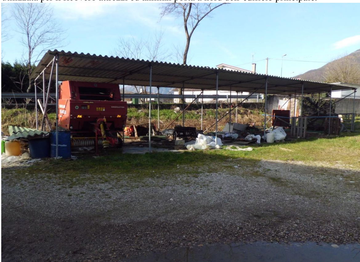
Foto n. 4 -24.01.2015 - Lotto n. 17 - Comune di Meduno fg.19 part.1757 - Tettoia utilizzata per il ricovero attrezzi posta a sud-ovest dell'edificio principale. Non risultano autorizzazioni comunali per la costruzione di questa struttura.
