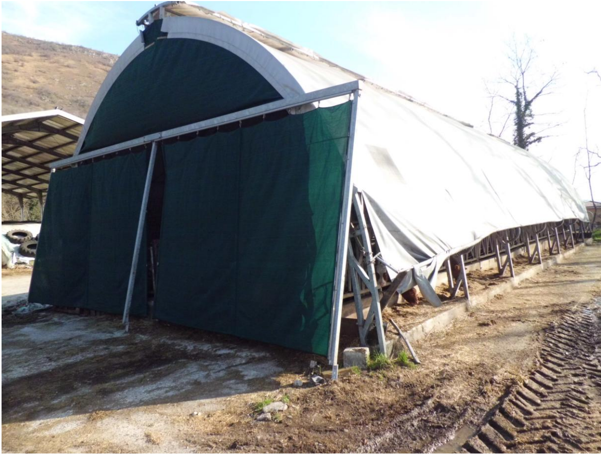
Foto n. 7 – 24.01.2015 – Lotti n. 17 e 18 - Comune di Meduno fg.19 part.1757 – Fabbricato utilizzato per il ricovero di animali. Tale tunnel ricade in porzione sulla particella 1933-ex945 (parte distale) e porzione sulla particella 1757. Foto scattata dalla par. 1757 lato sud. Sullo sfondo visibile la tettoia della precedente fotografia.
