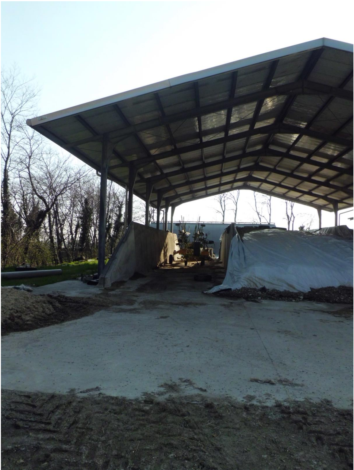
Foto n. 6 – 13.03.2014 – Lotti n. 17 e 18 - Comune di Meduno fg.19 part.1933 (ex945) – La particella risulta occupata in parte da un fabbricato. La tettoia visibile in foto ricade per porzione (parte sinistra) sulla particella 1933 e porzione (parte destra) sulla particella 1757, anch'essa oggetto di pignoramento. Foto scattata dal lato nord.
