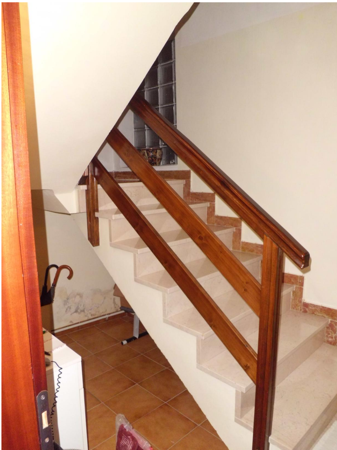
Foto n. 6 – 09.01.2015 – Lotto n. 16 - Comune di Meduno fg.19 part.853 – Vano scale che conduce al piano superiore. Evidenti le macchie di muffa ed umidità nel sottoscala.
