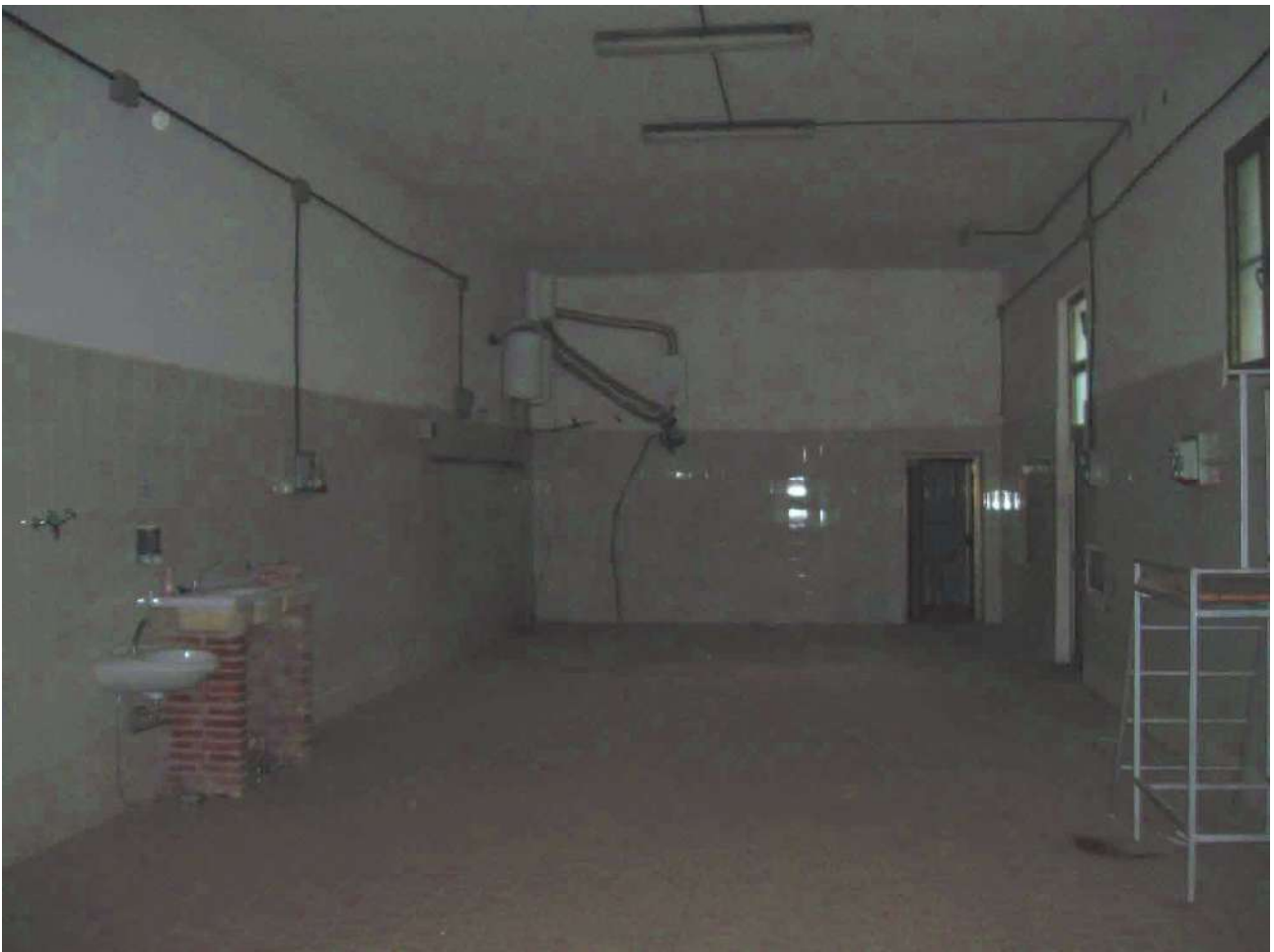
Foto 64 – Corpo 2C laboratorio particolare interno
