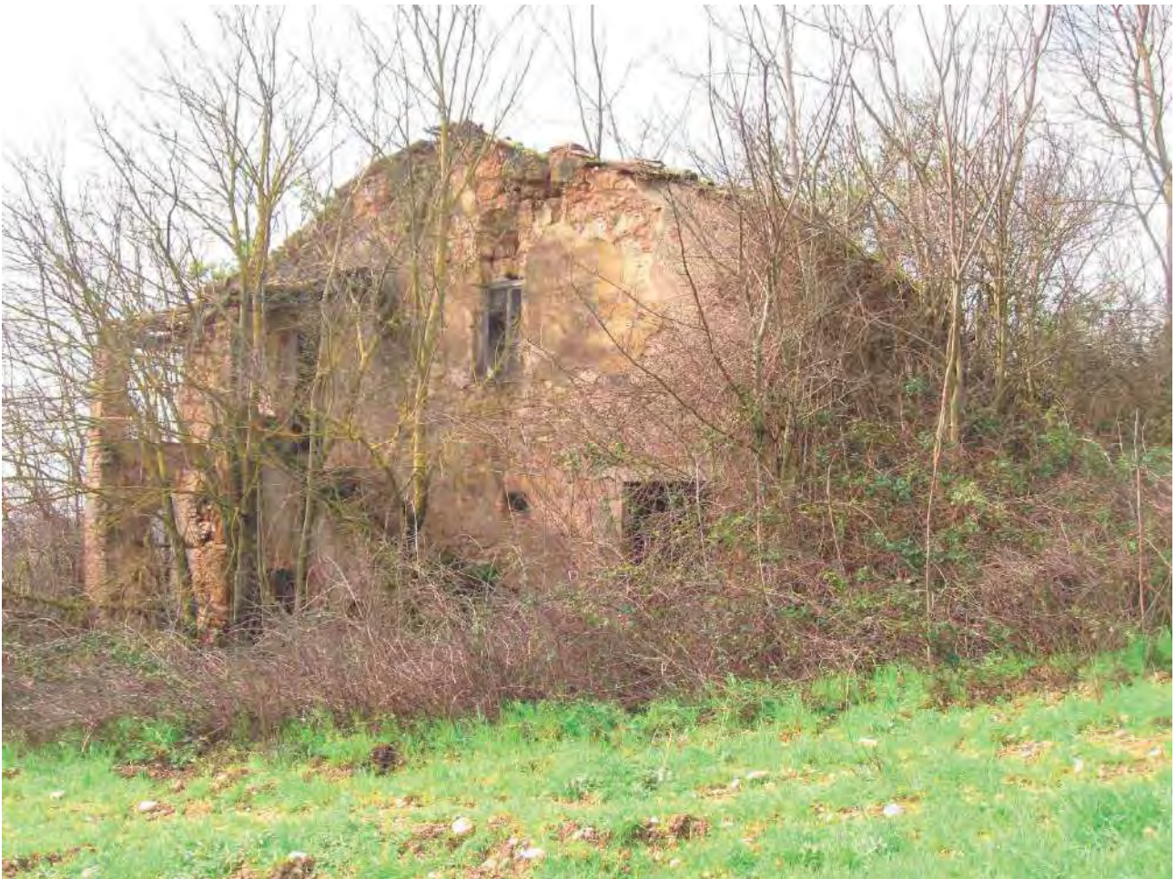
Foto 115 – Corpo 12 Fabbricato diruto – elementi visibili attraverso gli arbusti
