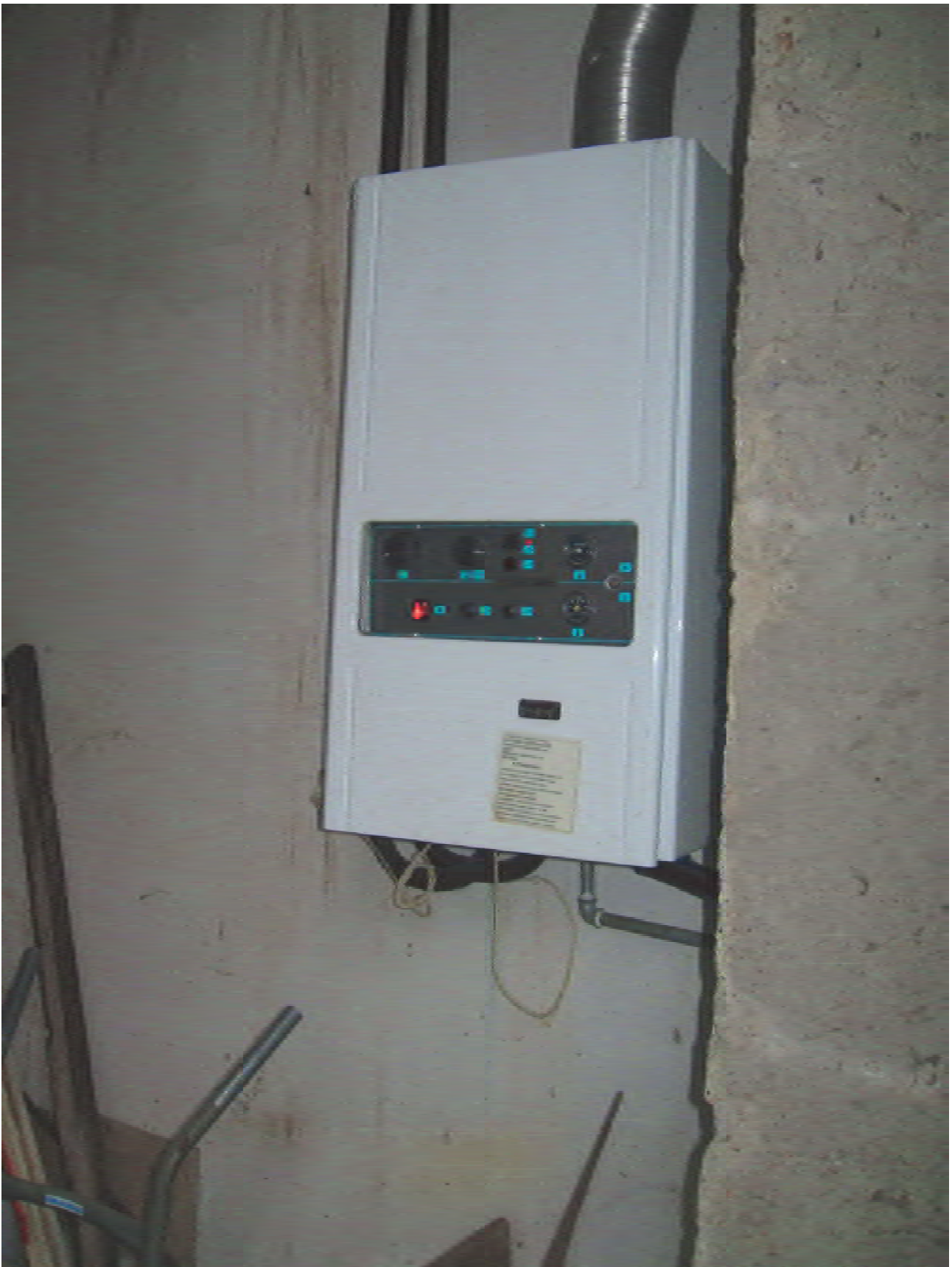
Foto 65 – Corpo 2D magazzini piano seminterrato particolare caldaia
