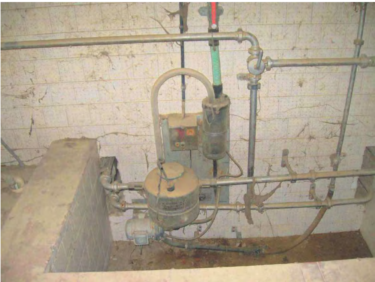
Foto 95 – Corpo 6 stalla – rimessa attrezzi – particolare interno impianti
