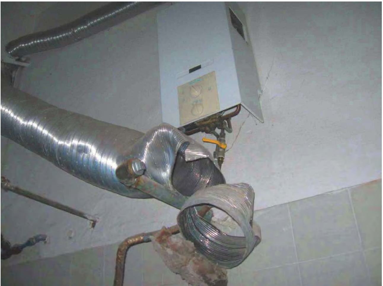
Foto 62 – Corpo 2C particolare caldaia
