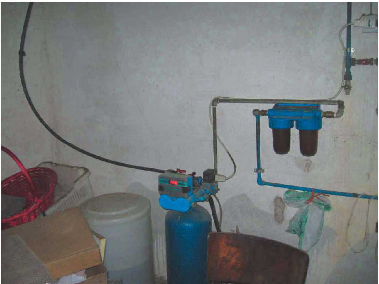
Foto 66 – Corpo 2D particolare depuratore acqua potabile
