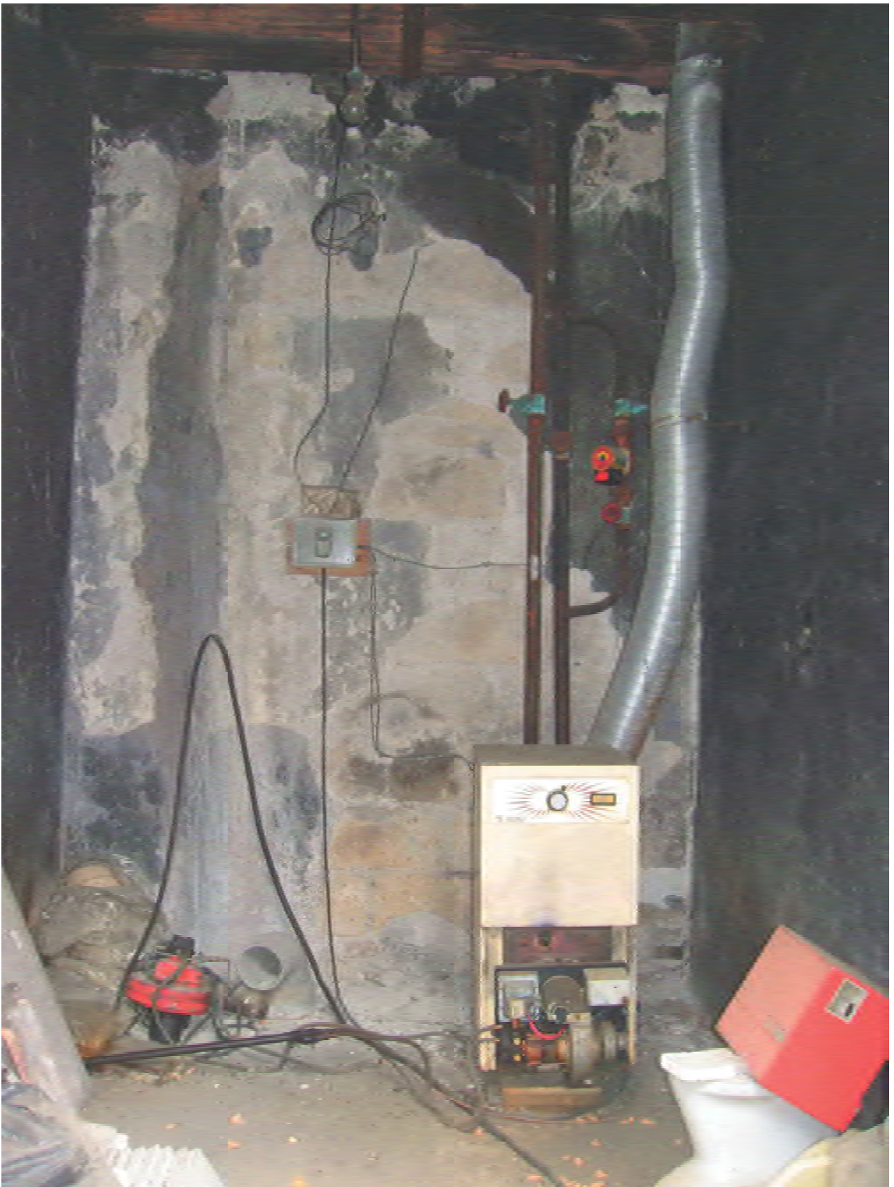
Foto 8 – Corpo 1 Particolare locale tecnico
