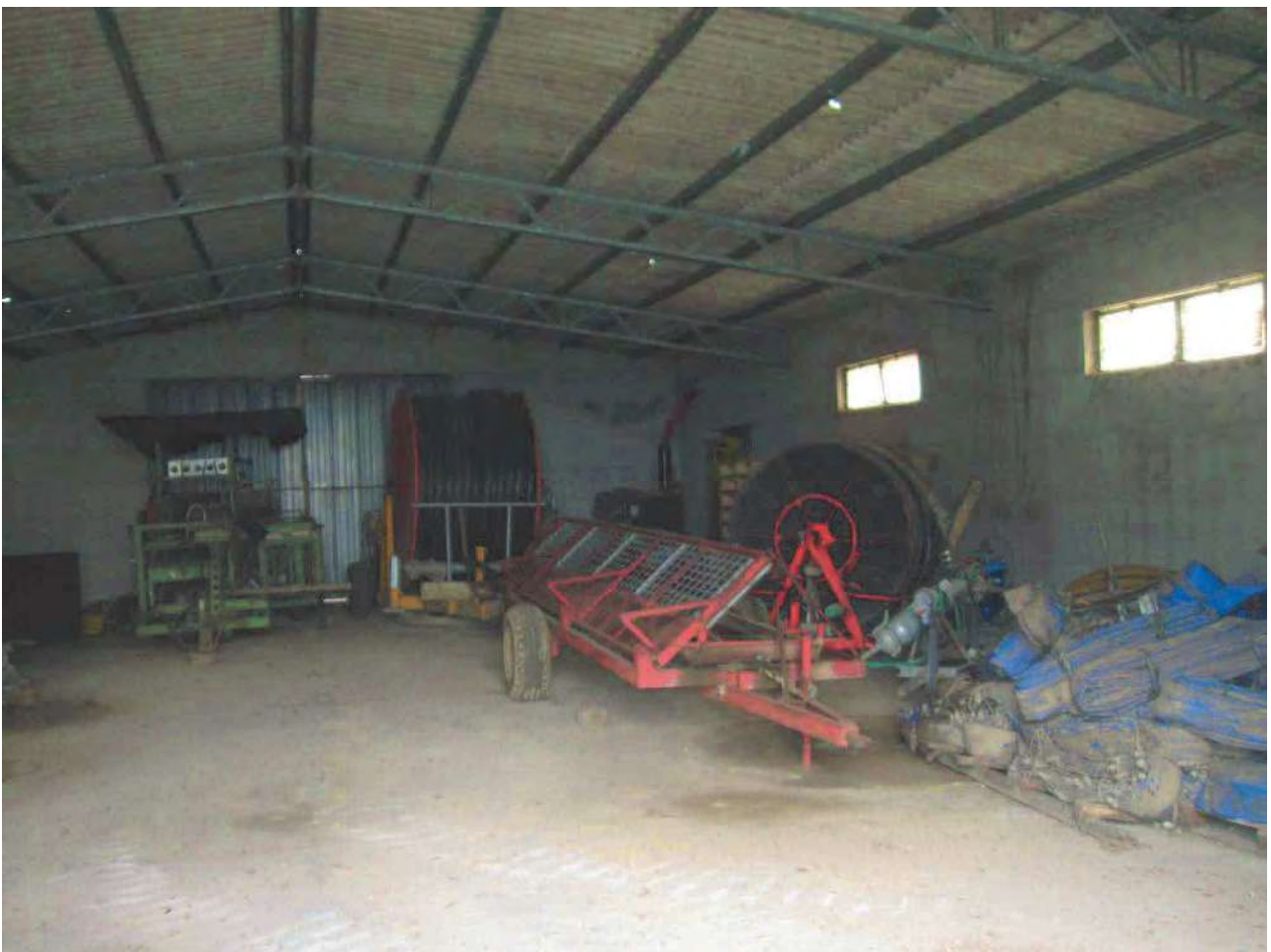
Foto 91 – Corpo 5 particolare interno e copertura in amianto danneggiata
