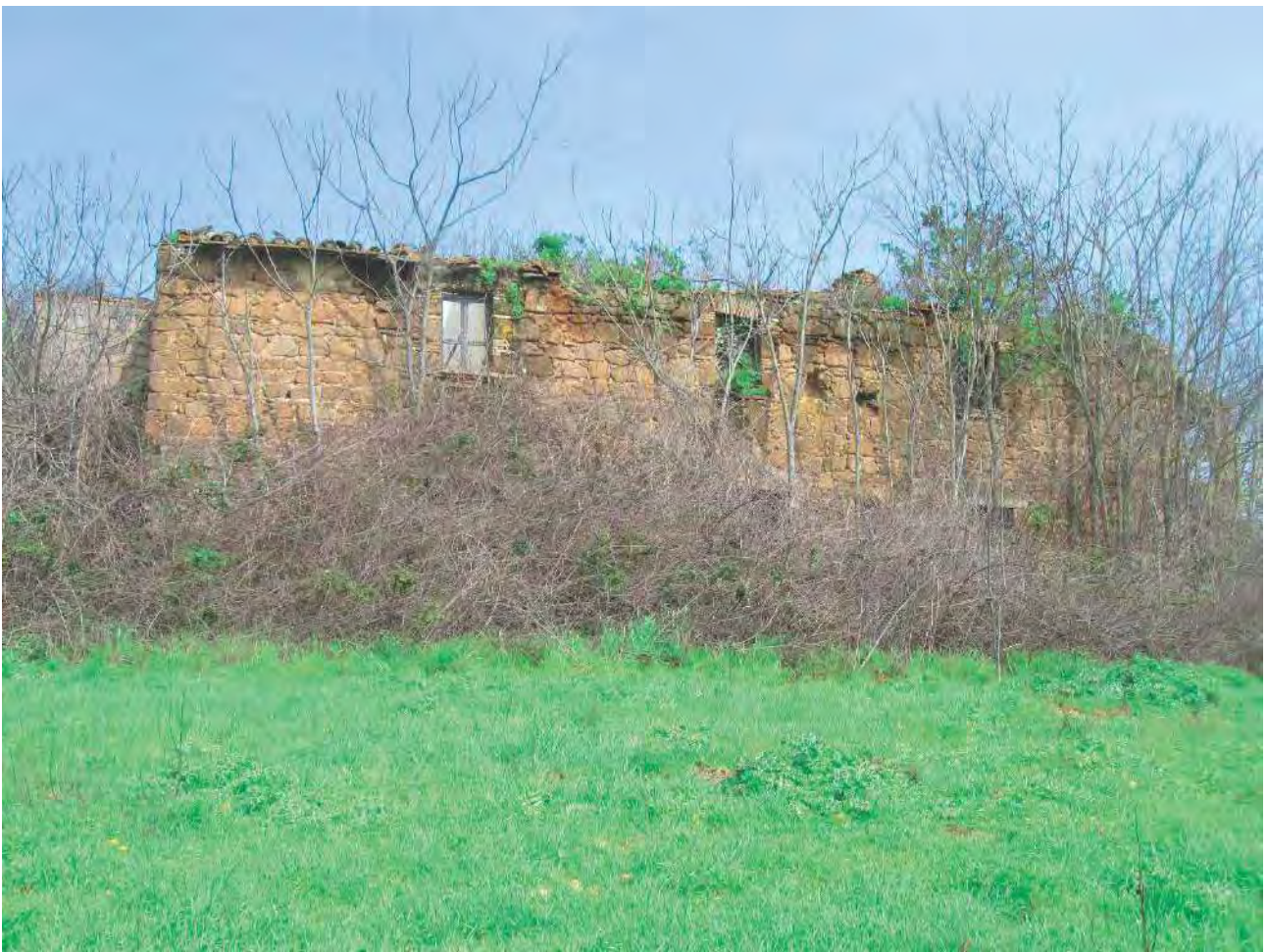
Foto 114 – Corpo 12 Fabbricato diruto – elementi visibili attraverso gli arbusti
