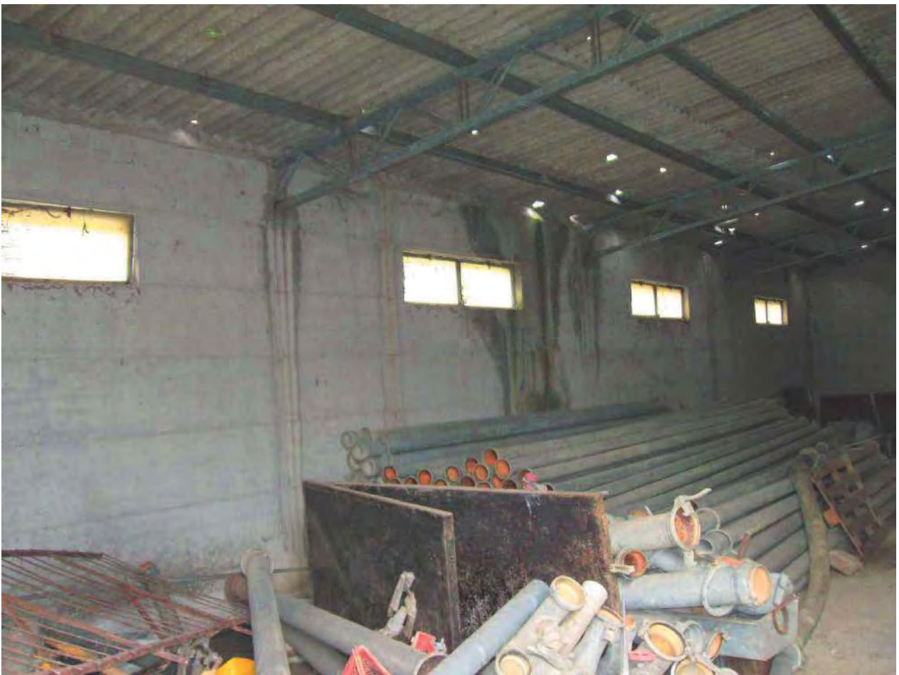
Foto 90 – Corpo 5 particolare interno e copertura in amianto danneggiata
