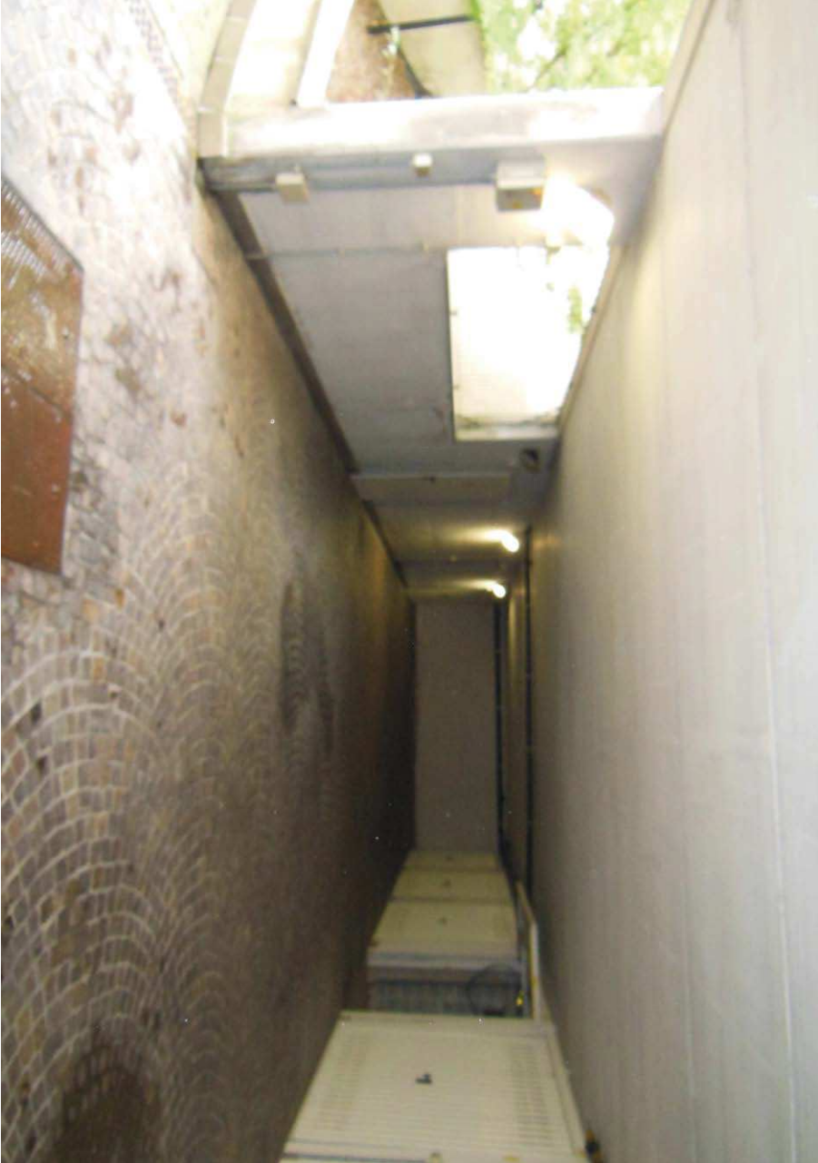
Foto 6: corsello comune d'accesso ai boxes
