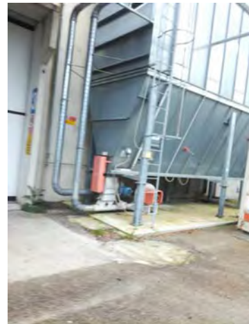
[68] Impianto di Aspirazione ed abbattimento polveri di legno_aLD.JPG
