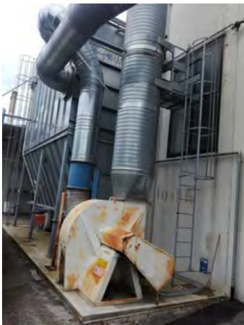
[71] Impianto di Aspirazione ed abbattimento polveri di legnoLD.JPG
