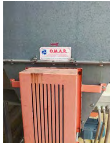
[70] Impianto di Aspirazione ed abbattimento polveri di legno_cLD.JPG
