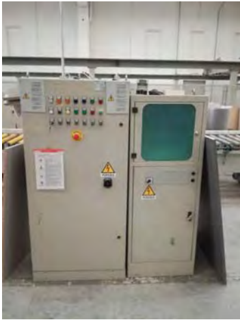
[33] Carro ponte prelevatore barre tops ESSE 2_ quadro comandiLD.JPG
