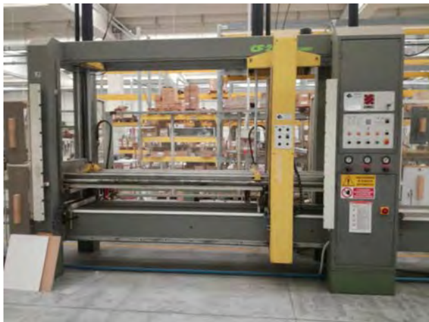
[109] Strettoio Passante COMIL CF 2000 JLD.JPG
