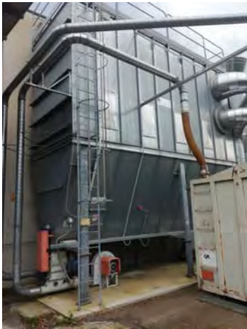
[69] Impianto di Aspirazione ed abbattimento polveri di legno_bLD.JPG
