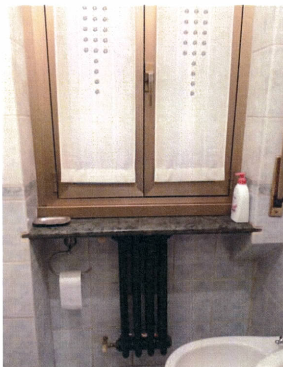
Infissi bagno e calorifero non funzionante
