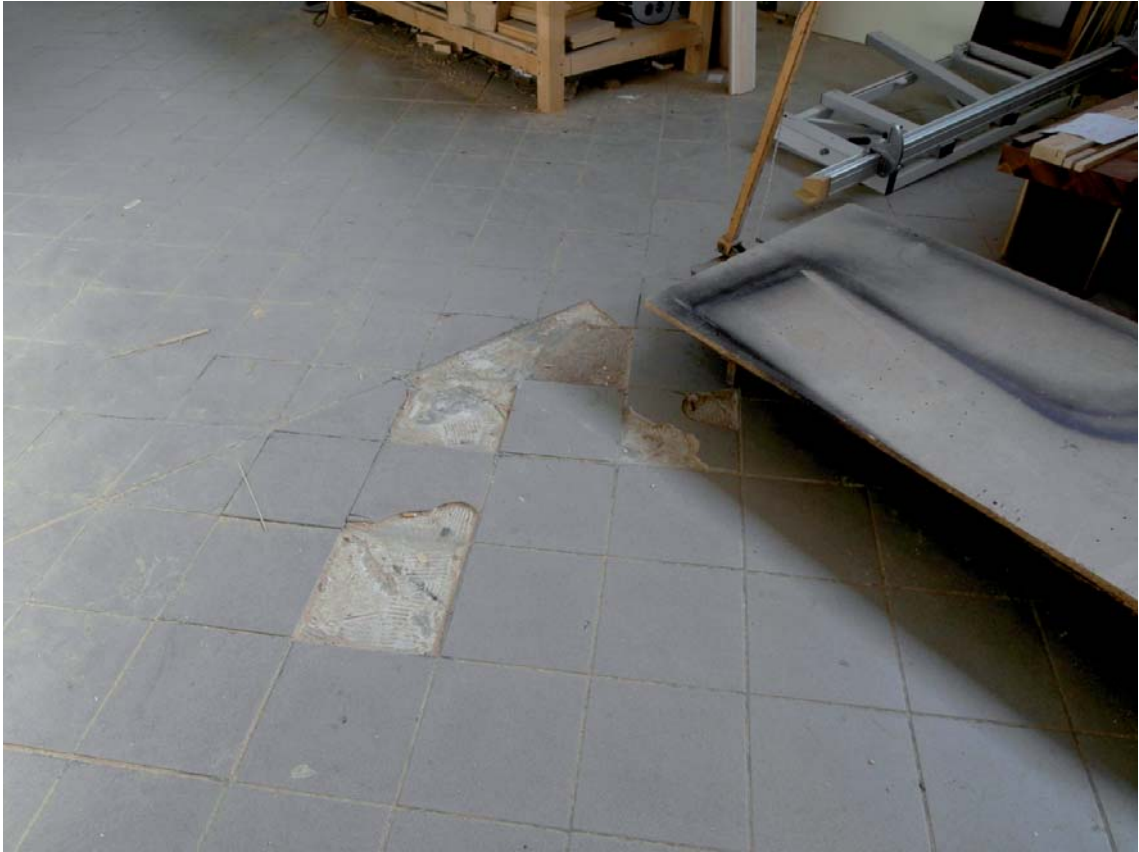
Foto n. 11: Particolare del pavimento del laboratorio (zona lievemente danneggiata).
