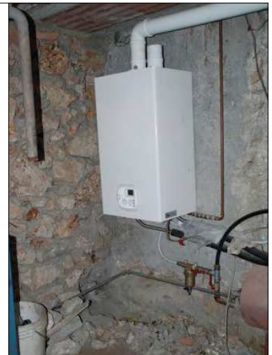
Foto del 12-11-2016 Locale tecnico - caldaia Fg. 54 part. 61 sub. 2
